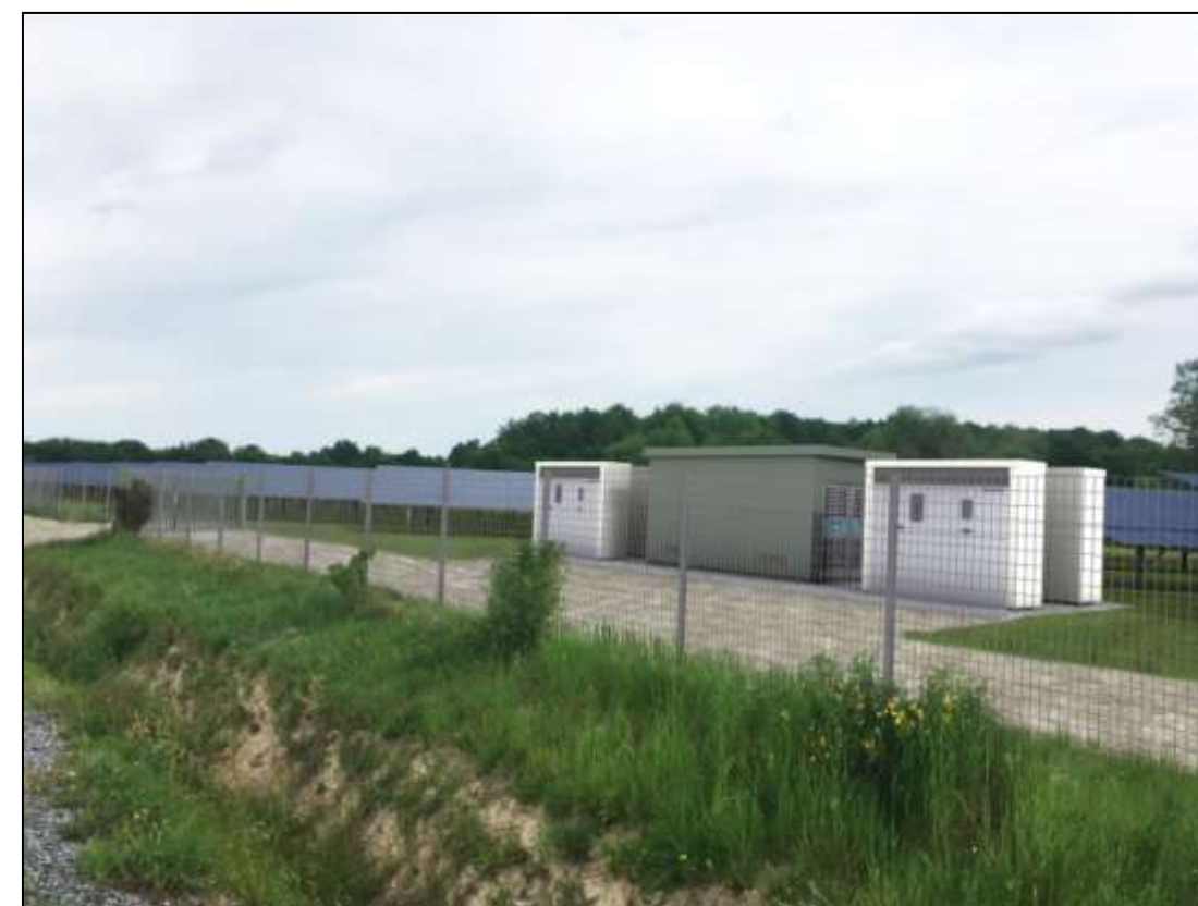
Figure 12 : Photomontage d'un poste de livraison de la centrale photovoltaïque du Grand Guéret
