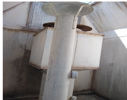
Foto 4. Ducto filtro segunda limpia
