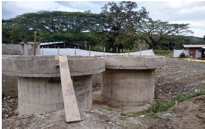
Foto 3- sedimentadores de flujo ascendente
