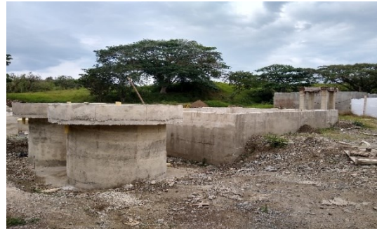
Foto 2 – De izquierda a derecha sedimentadores – regulación y separador de líquidos
