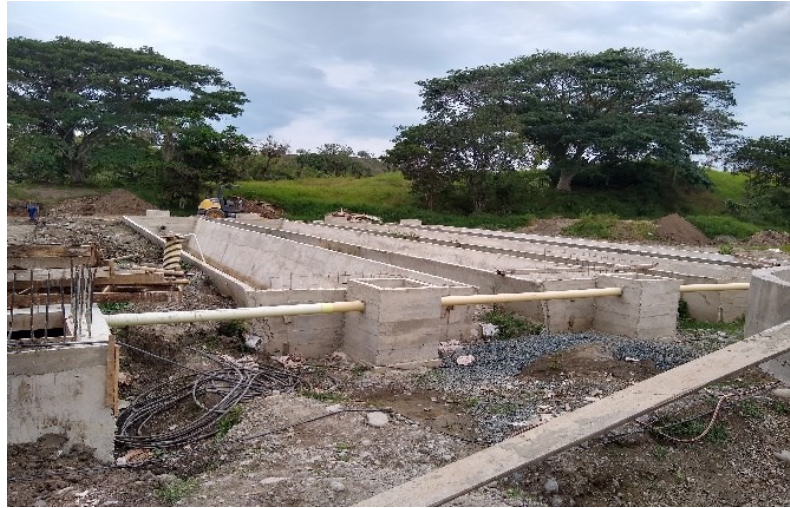
Foto 4 – Biodigestores con flujo en paralelo
