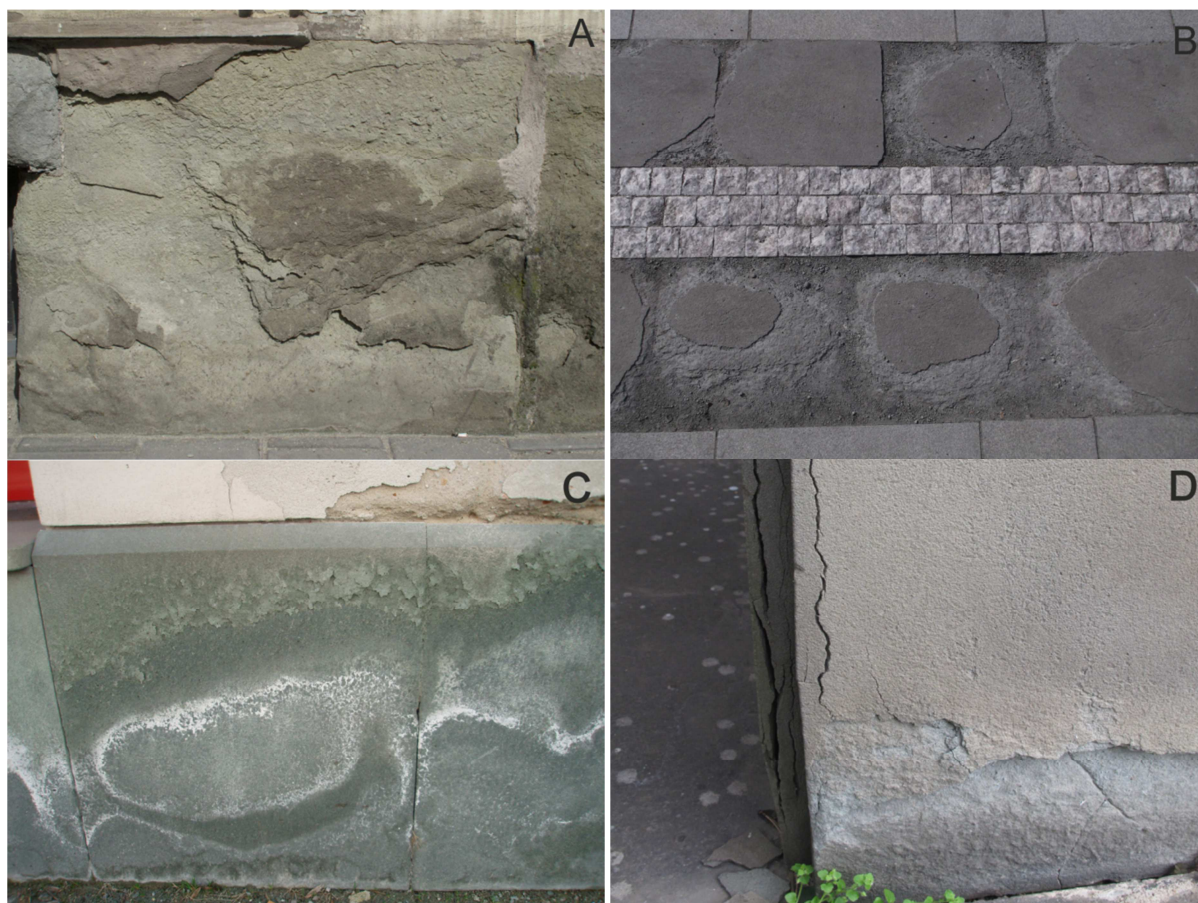
Obr. 4. Ilustrativní příklady degradace godulských pískovců ve stavbách ( A – výrazné odprsky na povrchu pískovcového bloku v základech budovy dnešního Divadla Jiřího Myrona v Ostravě, postavené v letech 1892-1894, B – ukázka rapidní celkové destrukce kamene po 10 leté expozici v exteriéru na příkladu dlažebních desek v přednádražním prostoru železničního nádraží Ostrava-Svinov, C – pískovcový obklad soklu domu na Zámeckém náměstí ve Frýdku-Místku s výraznými solnými výkvěty a šupinatěním povrchu, D – masivní exfoliace povrchu kamenného obkladu na jedné z budov Univerzity obrany v Brně po cca 60 letech působení povětrnosti).
