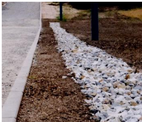
Fot. 18. Wykonanie drenażu francuskiego (fot. E. Kozłowska) Phot. 18. Realization of French drainage
