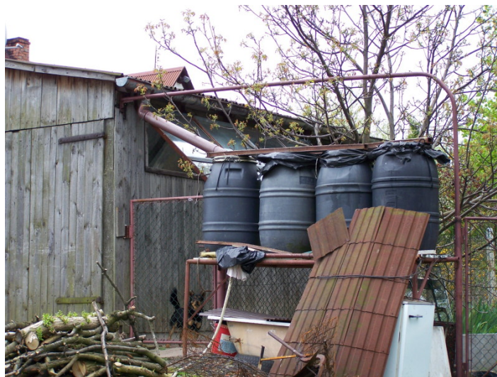
Fot. 23. Amatorski system gromadzenia wody z dachu (fot. E. Kozłowska) Phot. 23. Amateur system of rainwater collecting
