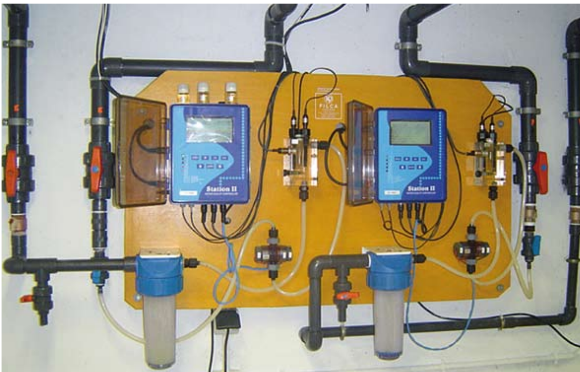
Sistema automatizado dosificación producto químico.
