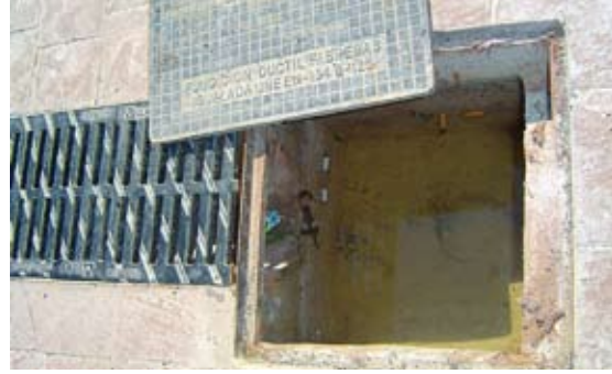
Arqueta-Arenero de la canal-colector de recogida de aguas.
