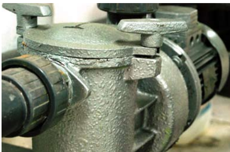
Grupo bombeo piscina.
