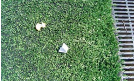
Suciedad acumulada sobre el césped artificial.
