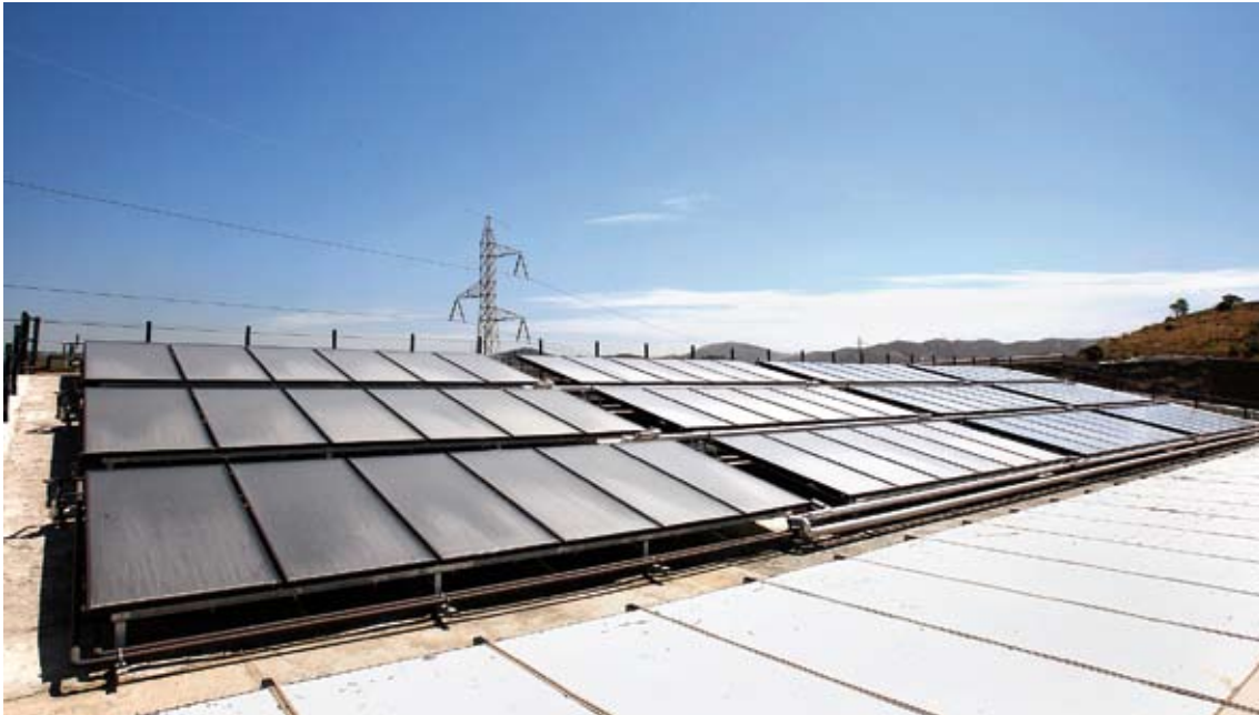
Captadores solares térmicos.
