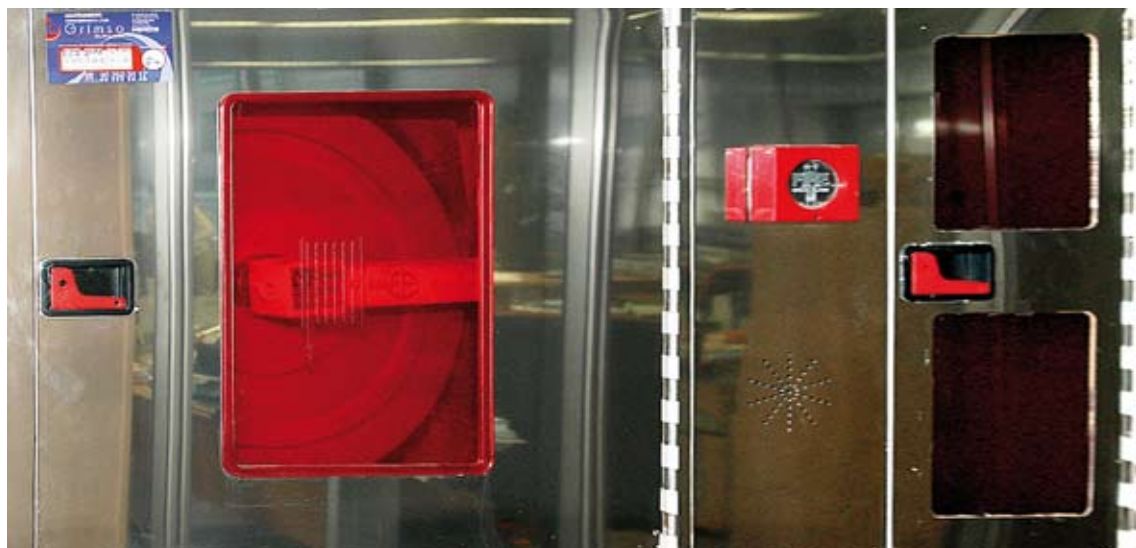
Armario BIE pulsador de emergencia y extintor.
