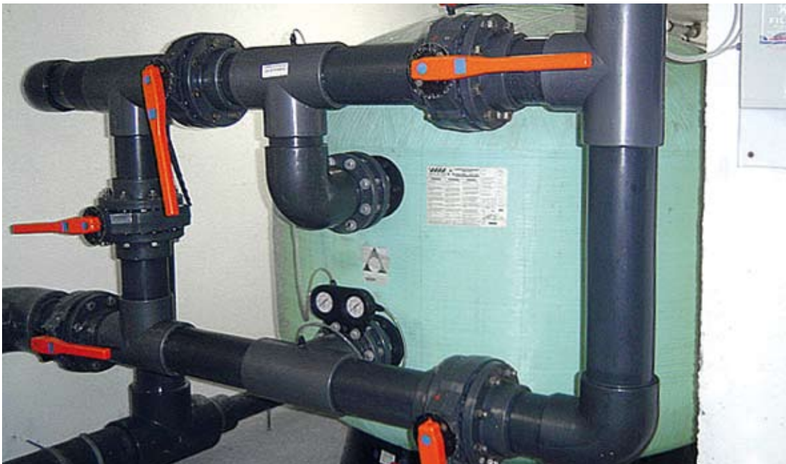
Filtro de arena o vidrio con batería de 5 válvulas.
