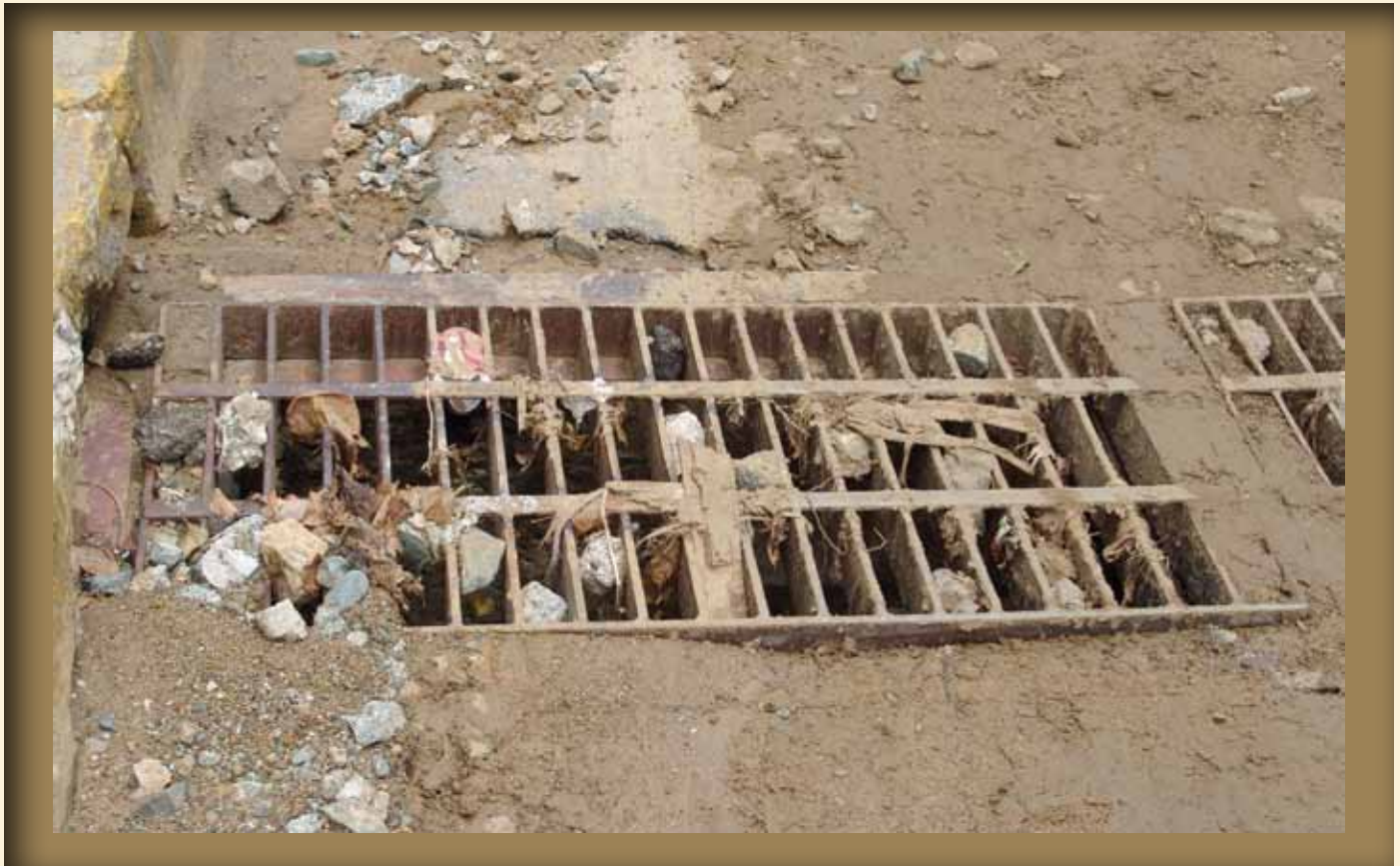
Foto número 5: Alcantarilla pluvial parcialmente obstruida debido a actividad de construcción en Humacao.
