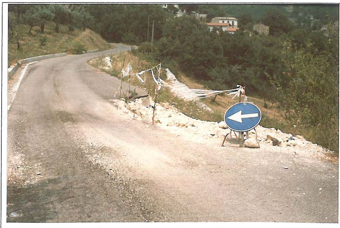
Figura 11.6: Effetti di una frana nei depositi flyschoidi arenaceo - pelitici sul tracciato stradale di Pescosansonesco
