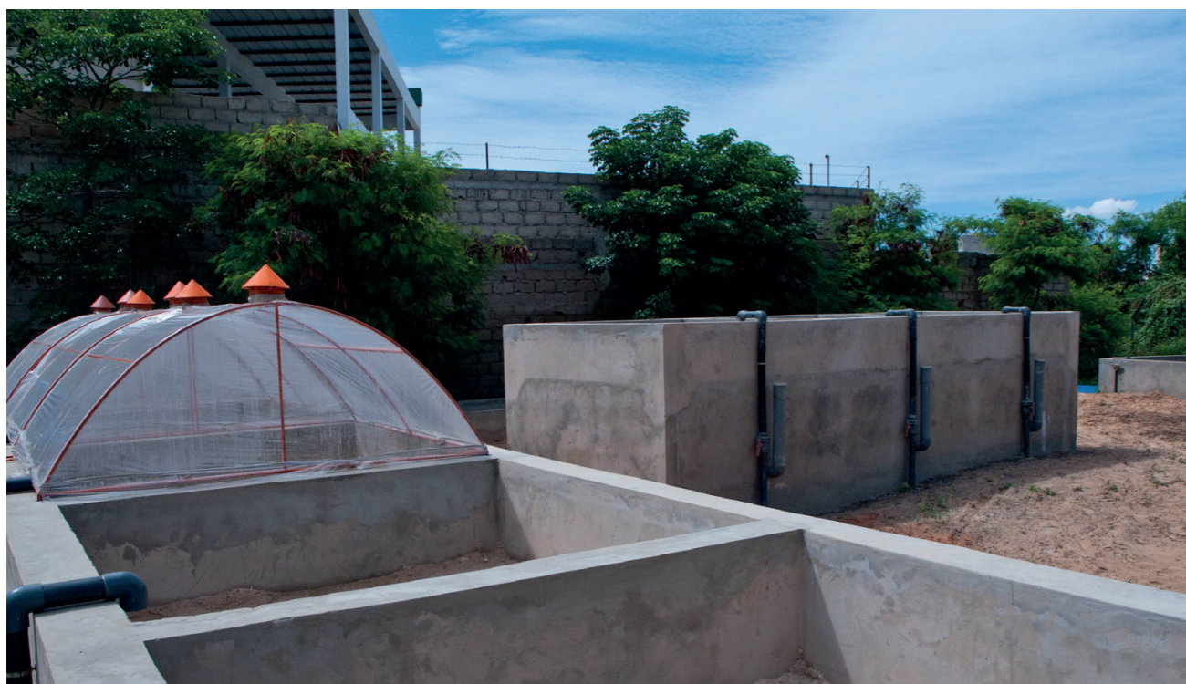
Figura 7.7 Proyecto piloto acerca de la separación del agua presente en los lodos fecales, mediante invernaderos con ventilación activa y pasiva, dentro de la Estación de Tratamiento de Lodos Fecales Cambérène, en Dakar, Senegal (foto: Linda Strande).
