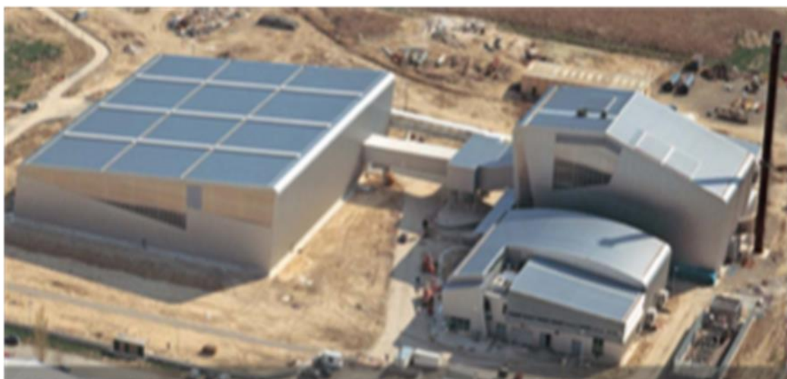
Figura10.37. Vista aérea de la planta de generación eléctrica de 25 MW a partir de paja cereal y otros residuos forestales de Sangüesa (Navarra, España) al final de su construcción en 2006. (Fuente Acciona Energía e IDAE)
