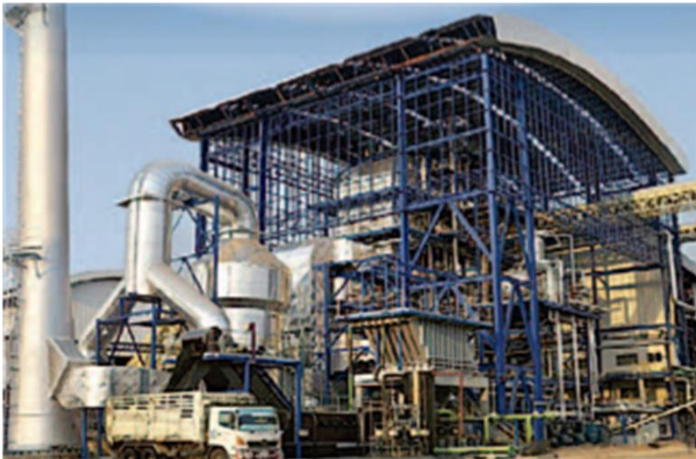
Figura 10.45. Caldera que utiliza bagazo en la planta de azúcar de Mid Siam Sugar Co. Ltd., Tailandia, 2009. (Fuente ISGEC Group).
