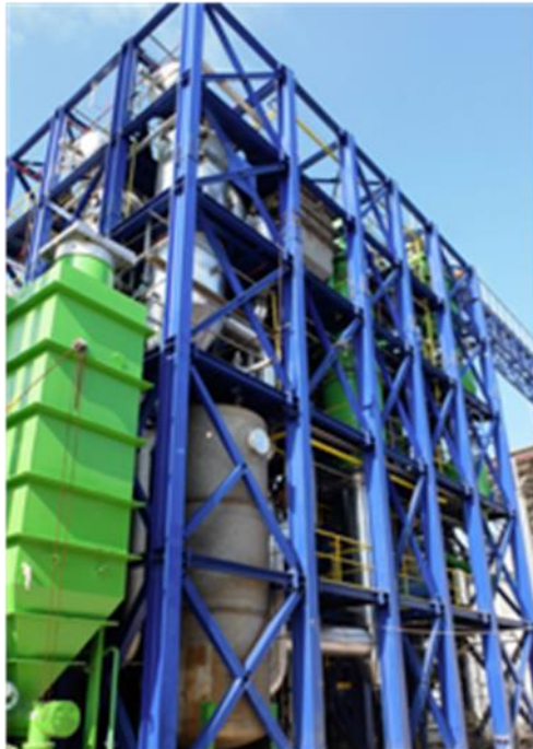
Figura 10.27. Vista general de la planta de cogeneración de 4 MW eléctricos de EQTEC, usando paja de trigo.
