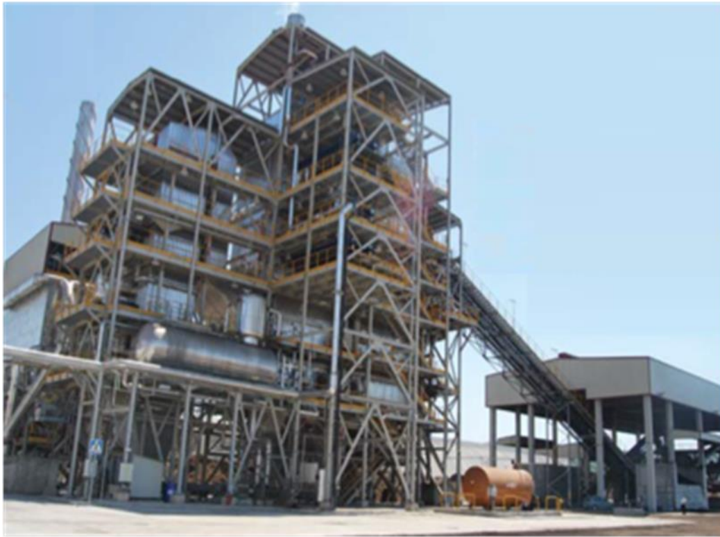
Figura 10.48. Planta de Tratamiento Integral del Alperujo en Linares (Jaén, España) de 2009. Compuesta de secado de alperujo con motores de cogeneración con gas y caldera, de alperujo y otra biomasa, conectada a una turbina-alternador de 15 MW. (Fuente InfoEnviro –InfoPower julio/agosto 2011).
