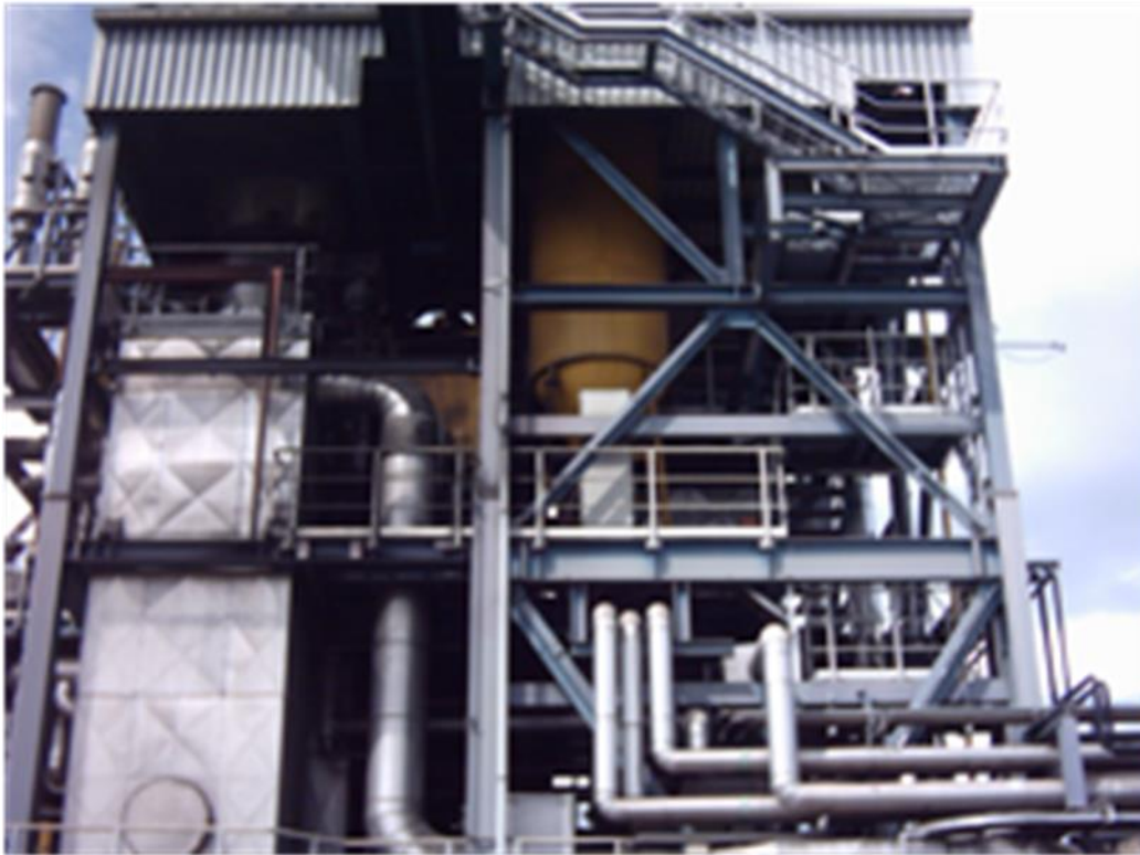
Figura 10.62. Planta de gasificación de biomasa.
