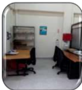
Área de trabajo y panel de incendio
