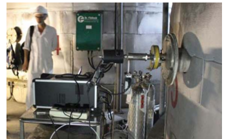
發電廠的排放監控
