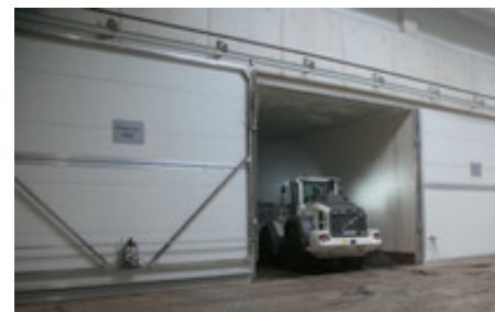
Tunnel di compostaggio
