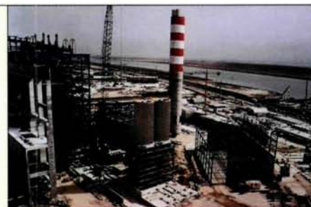
Inceneritore di rifiuti (con produzione di elettricità) a Lisbona
