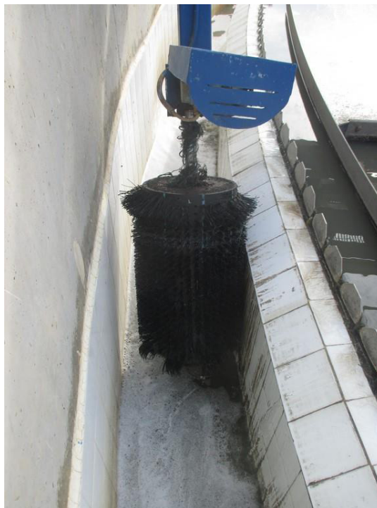
Figure I. 18: Brosse de nettoyage de la rigole des eaux clarifiées
