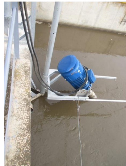
Figure I.17 : Aérateur à hélice
