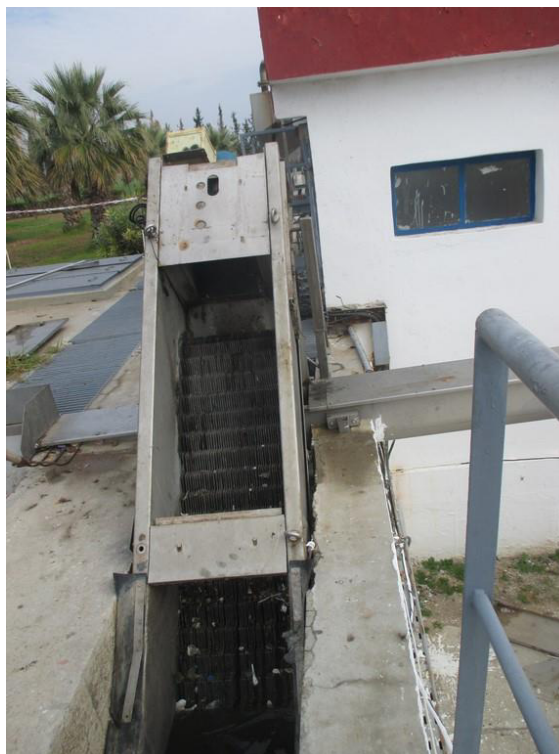
Figure I.13: Dégrilleur à gradin
