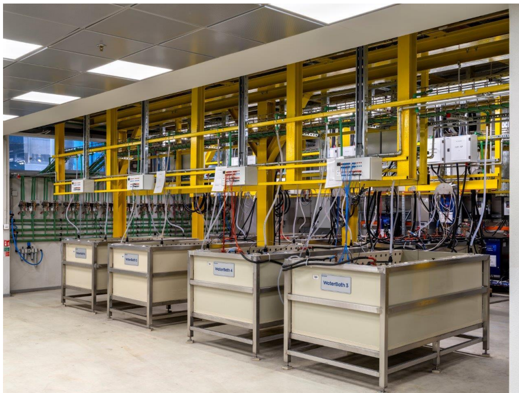
Φωτογραφία 15.12: Άποψη των μπάνιων ηλεκτροδίων Ag-Zn
