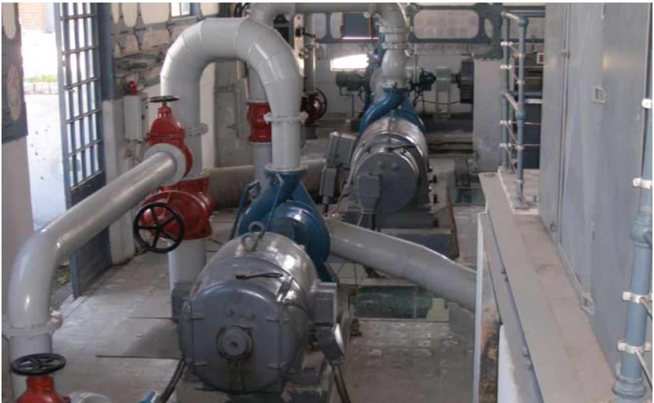
Μηχανολογικές εγκαταστάσεις διανομής νερού
