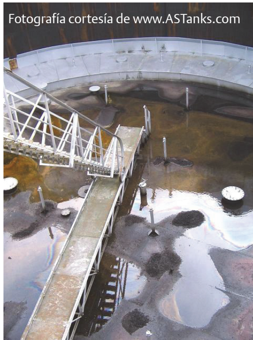
Figura 1-10. Un drenaje de techo que funciona mal es un problema común.
