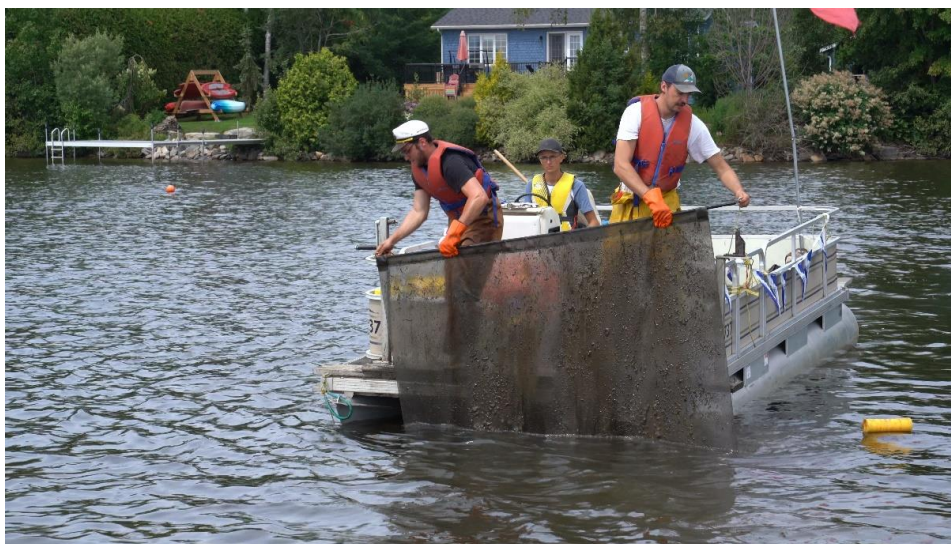
Plateforme flottante qui peut être utilisée à la fin de l'été pour retirer du fond de l'eau une toile de fibre de verre (photographie : Vincent Gagné)
