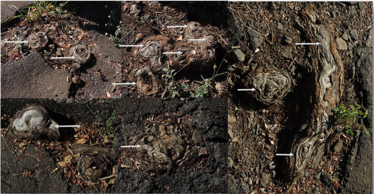
Figura 48 – Detalhe dos pneumatóforos (setas) rompendo o asfalto
