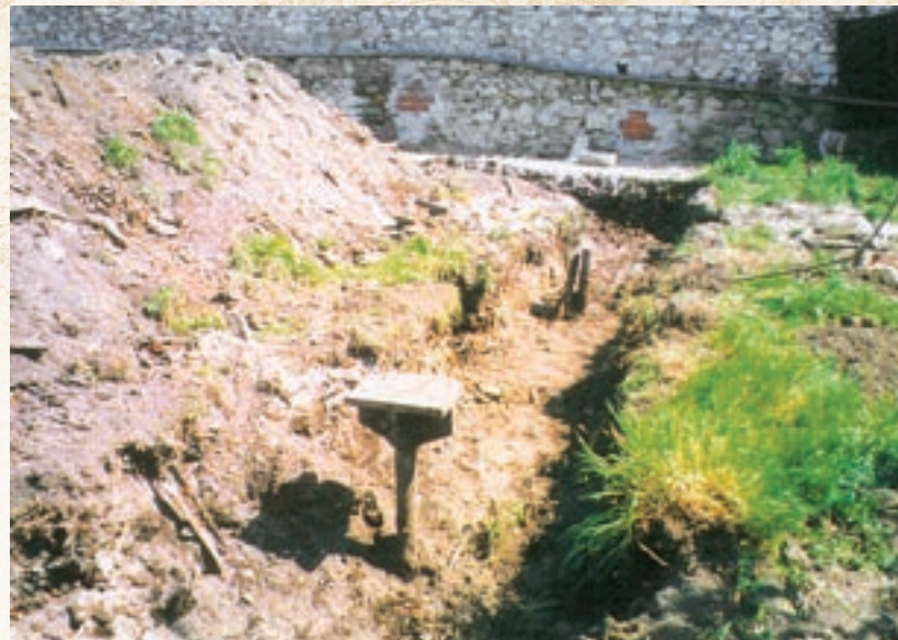
Εικ. 222. Βάσεις για τη στερέωση της αποβάθρας και τη γραμμή του μικρού τρένου Decauville (φωτ. Αθ. Χατζηγγώγας)
