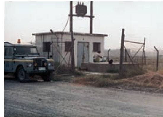
Εικ. 180. Οικίσκος ηλεκτροκίνητης γεώτρησης K2. Ο υπάλληλος διενεργεί δειγματοληψία και έρευνα της ποιότητας του νερού
