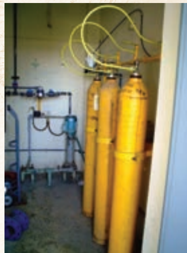
Εικ. 279. Φιάλες χλωρίου 50 χγρ. στο αντλιοστάσιο ΒΙΠΕΘ
