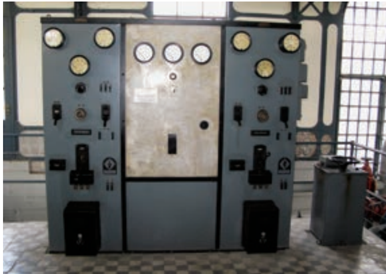
Εικ. 231. Ο ηλεκτρικός πίνακας που λειτουργούσε στο Κ.Α.Σ. το 1948, όπως εκτίθεται σήμερα
