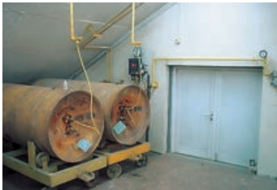
Εικ. 188. Εγκατάσταση φιαλών άνυδρου υγρού χλωρίου των 900 χγρ.
