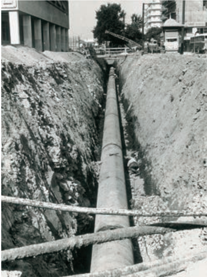
Εικ. 175. Η κατασκευή του αγωγού Φ800 το 1970, μπροστά στον ΟΤΕ, στο Βαρδάρη (πλ. Δημοκρατίας). Ο αγωγός λειτουργεί και σήμερα με την ακόλουθη πορεία: Αντλιοστάσιο Δενδροποτάμου → πλατεία Δημοκρατίας Φ800→ Εγνατία Φ500→ Σιντριβάνι Φ600→ Πανεπιστημίου→ δεξαμενή Ευαγγελίστριας→ αντλιοστάσιο. Μάλιστα υδροδοτεί συγχρόνως και το κέντρο της πόλης, και γι' αυτό θα θυμούνται οι παλιότεροι ότι σε καιρούς λειψυδρίας, ενώ οι γύρω συνοικισμοί υπέφεραν από έλλειψη νερού, το κέντρο πάντα είχε έστω λιγοστό, αφού περνούσε υποχρεωτικά από τον αγωγό Φ500, για να προωθηθεί και στις άλλες δεξαμενές
