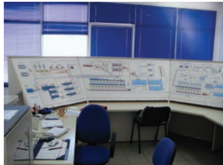
Εικ. 272. Τράπεζα χειρισμών και ελέγχου του διωλιστηρίου
