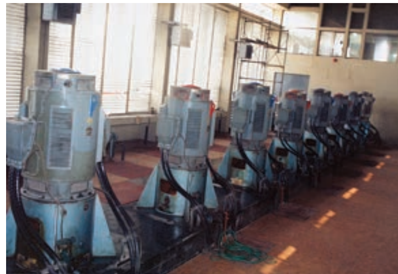
Εικ. 277. Χώρος στο αντλιοστάσιο Δενδροποτάμου όπου γίνεται η χλωρίωση του νερού των πηγών Αραβησσού
