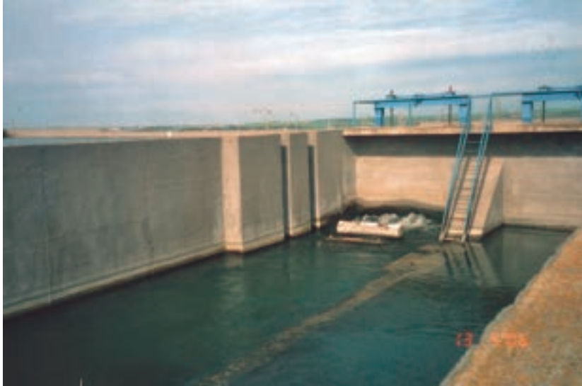
Εικ. 266. Η υποδοχή της δεξαμενής εισόδου του νερού στο διυλιστήριο (Εγκατάσταση Επεξεργασίας Νερού)
