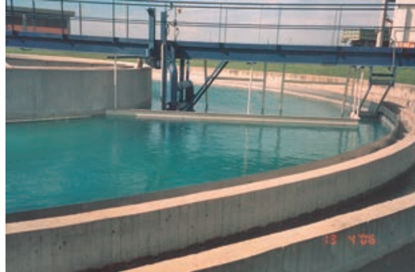
Εικ. 267. Δεξαμενή κροκίδωσης-καθίζησης
