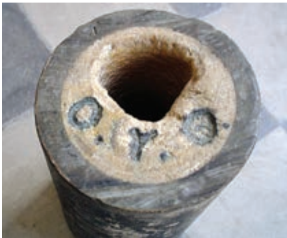
Εικ. 173. Αγωγός ύδρευσης που γέμισε πουρί (ανθρακικό ασβέστιο)
