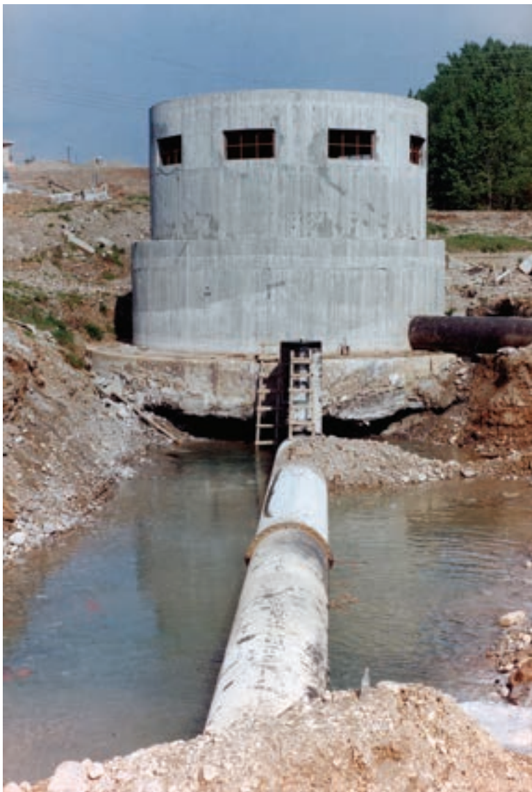
Εικ. 211. Το συγκεντρωτικό φρεάτιο των πηγών Αραβησσού, κατά την κατασκευή του το 1977
