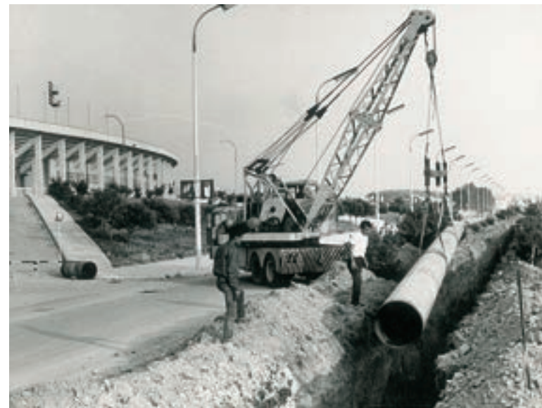
Εικ. 164. Κατασκευή του αγωγού Φ800 έξω από το Καυτανζόγλειο, που ξεκινούσε από το αντλιοστάσιο Κασσάνδρου, και περνούσε από την οδό Κασσάνδρου, την Ευαγγελίστρια, την Αγ. Δημητρίου, το Καυτανζόγλειο και την Τριανδρία, για να καταλήξει στη δεξαμενή Τούμπας (Κρουονερίου). Ο αγωγός λειτουργεί και σήμερα, και τροφοδοτεί με νερό τις ανατολικές συνοικίες της πόλης (Τούμπα, Χαριλάου, Πανόραμα, Καλαμαριά κ.λπ.)
