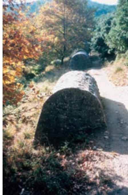
Εικ. 256. Χτιστά φρεάτια επισκέψεως των εγκαταστάσεων, αμέσως μετά την υδρομάστευση της πηγής. Εκεί υπάρχουν μικρές κατασκευές για την καθίζηση και τον καθαρισμό των φερτών υλών, καθώς και για τη μέτρηση της ποσότητας του νερού και τις υπερχειλίσεις
