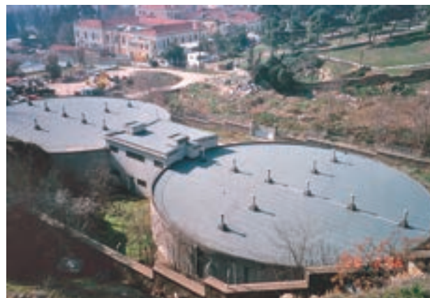
Εικ. 167. Η δίδυμη δεξαμενή της Ευαγγελίστριας, που υδροδοτεί το κέντρο της πόλης
