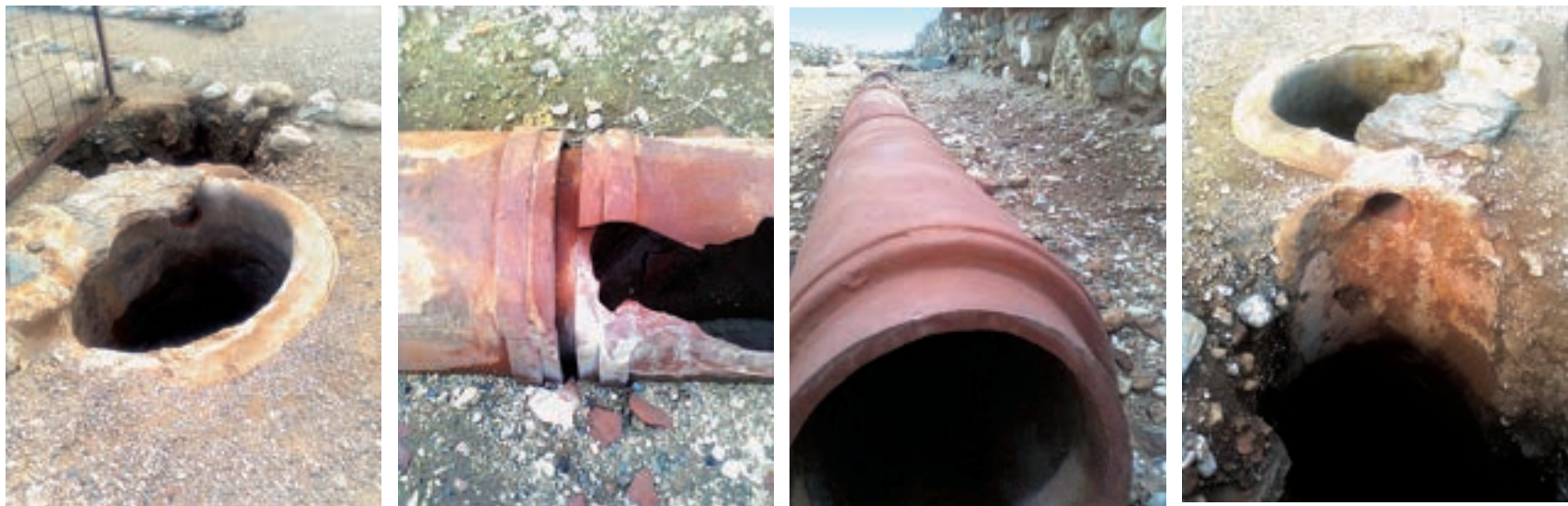
Εικ. 2. Εικόνες από την αρχαία Όλυνθο, που μαρτυρούν προηγμένα συστήματα ύδρευσης και αποχέτευσης: πήλινοι αγωγοί με σύστημα σύνδεσης αρσενικό - θηλυκό, όπως περίπου και το σημερινό, για να αποφεύγονται οι διαρροές και για να επιτυγχάνεται εύκολα η σύνδεσή τους
