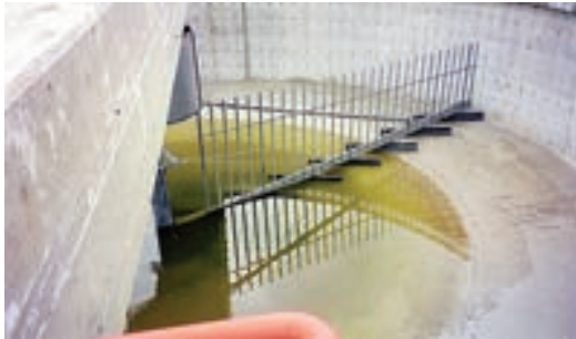
Εικ. 268. Τα ξέστρα του πυθμένα της δεξαμενής κροκιδώσης-καθίζησης
