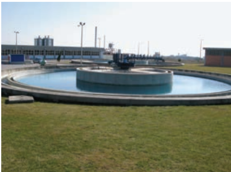
Εικ. 271. Δεξαμενή κροκιδώσης-καθίζησης
