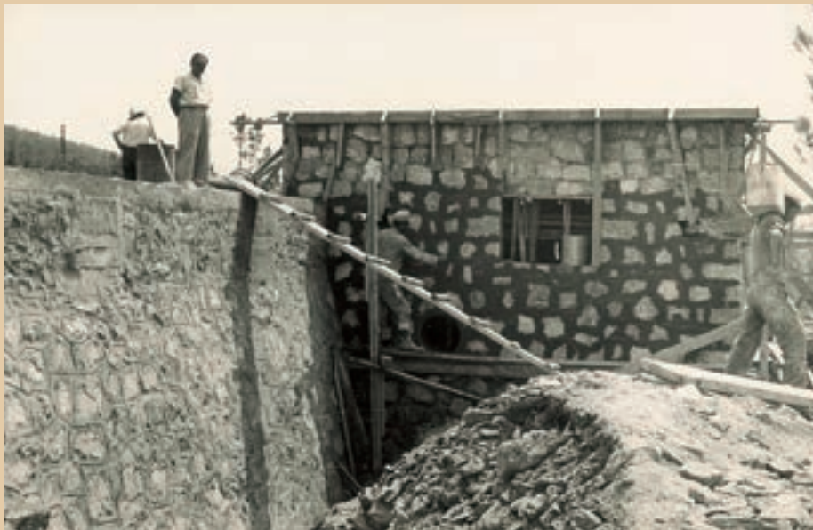
Εικ. 159. Εικόνες από την κατασκευή της πετρόκτιστης δεξαμενής στη Δενδροφυτεία Συκεών το 1954-55, που λειτουργεί και σήμερα, παίρνοντας νερό από το αντλιοστάσιο της δεξαμενής Καλλιθέας. Στην ίδια δεξαμενή κατέληγε και το νερό των πηγών του Ρετζιζίου, μέχρι την παύση της λειτουργίας τους, το 1985, λόγω μείωσης και μόλυνσης του νερού. Στη δεξαμενή χλωριωνόταν το νερό με υποχλωριώδες ασβέστιο. Επίσης υπήρχε εγκατάσταση για την προδιάλυση της χλωρασβέστου μέχρι το 1975, που αντικαταστάθηκε με υποχλωριώδες νάτριο. Στη νότια πλευρά της δεξαμενής υπήρχε αντλιοστάσιο που έστελνε νερό στη δεξαμενή Επταπυργίου, για την κατανάλωση των περιοχών Συκεών, Νεάπολης, Βάρνας κ.τ.λ.
