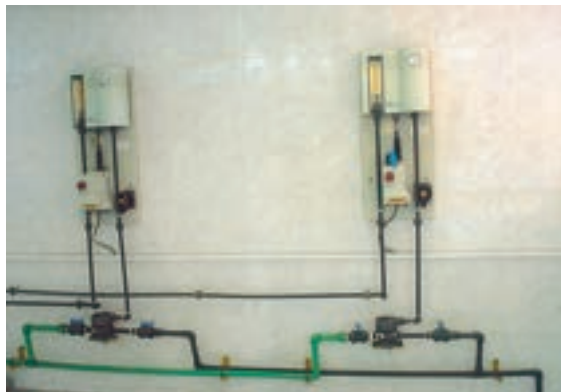
Εικ. 187. Εγκατάσταση χλωριωτήρων με αέριο χλώριο
