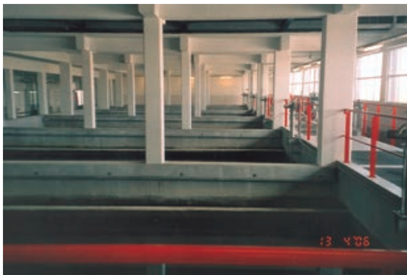
Εικ. 265. Το εσωτερικό της Εγκατάστασης Επεξεργασίας Νερού στη Ν. Ιωνία
