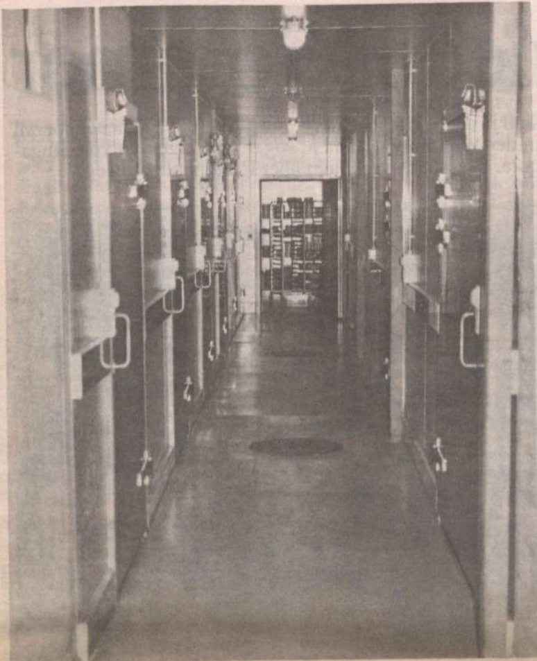
In der sechsten Bauetappe entstanden im Inneren des Felsens die modernsten Kühlanlagen der Schweizer Hotellerie.
