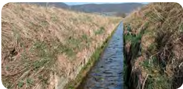
Avant la remise en valeur des berges: les murets de renforcement en béton sont des obstacles pour les petits animaux.
