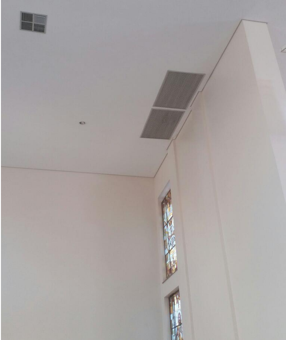
Figura 9 – Sistema de ar condicionado da Igreja do Rosário e iluminação
