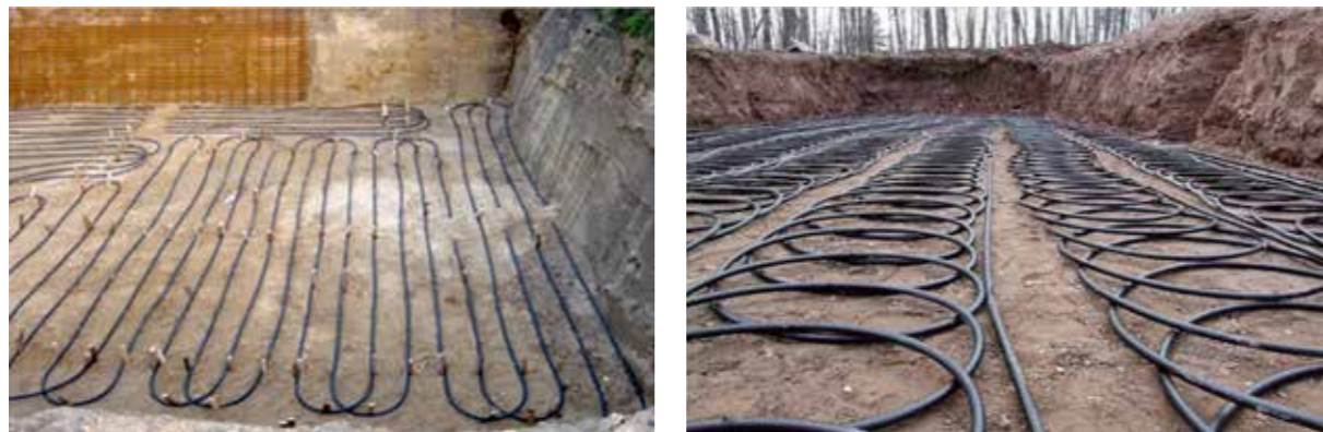
Foto 12. Configurazioni dei collettori orizzontali: a doppio meandro (sinistra); a spirale (destra) (foto Oberthal Energy s.r.l.).
