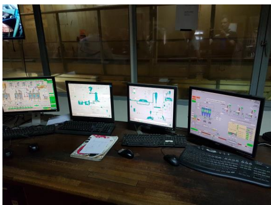
Κέντρο ελέγχου λειτουργίας βιομηχανίας παραγωγής προϊόντων ξύλου
