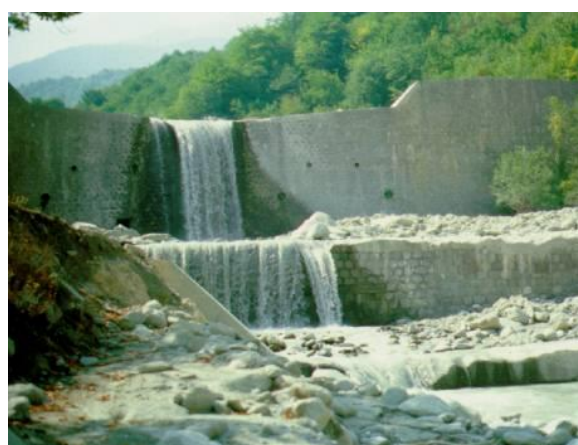
Φράγμα συγκράτησης φερτών υλών στο χειμαρρο Όρμας Αριδαίας
