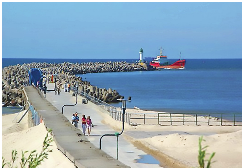
Рис. 20. Пример защиты внешнего мола и акватории порта Вентспилс (Балтийское море), внешний мол укрепленный фигурными массивами (тетраподы, трибары, стабиты); глубина вблизи маяка до 15 м.
