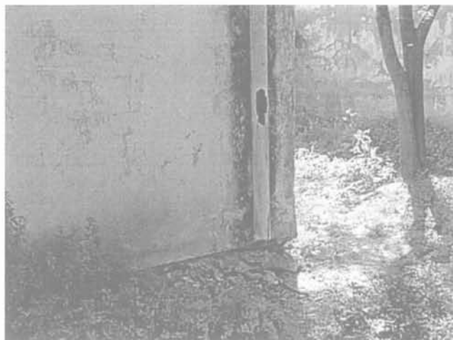
FIG. 18 Descente d'eau défectueuse au niveau des fondations d'un poteau et présence d'arbres très proches de la structure. Roof downspout drop on top of the foundation of a column and presence of trees very close to the structure.
