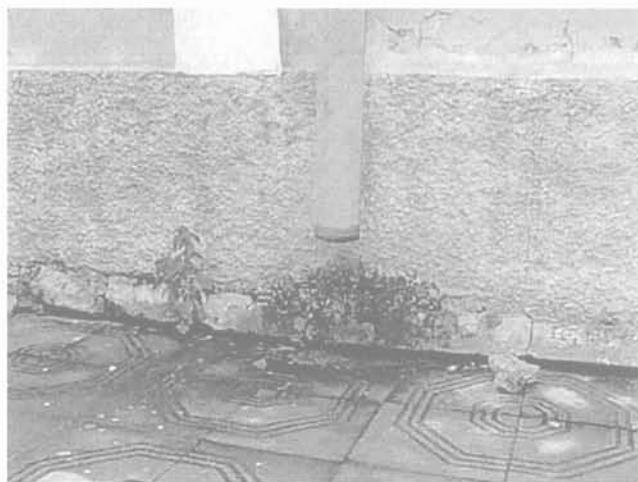
FIG. 17 Descente d'eau évacuant l'eau au-dessous du plancher. Roof downspout draining water underneath slab.
