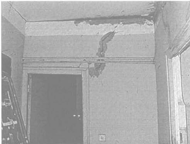
FIG. 6 Fissures dans la maçonnerie. Cracks in masonry.
