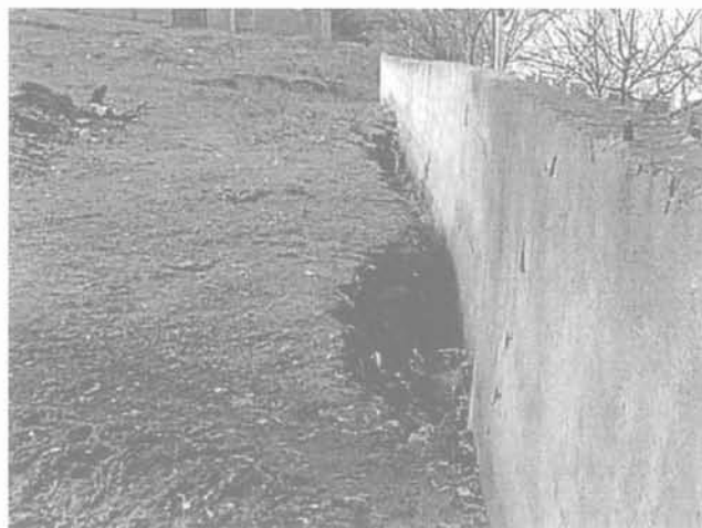
FIG. 19 Effet de l'eau provenant de la colline sur le mur de soutènement. Effect of water from a hill on the retaining wall.
