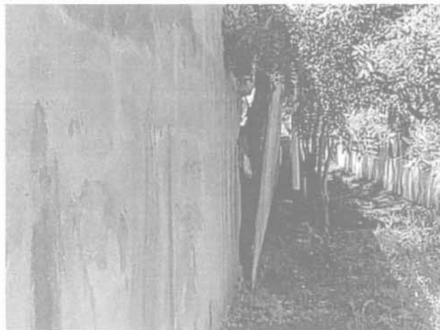
FIG. 9 Rupture partielle d'un mur de soutènement. Partial failure of a retaining wall.
