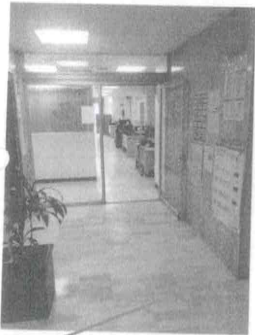
INCLINACIÓN DE LA LOSA EN TODOS LOS NIVELES DEL EDIFICIO
