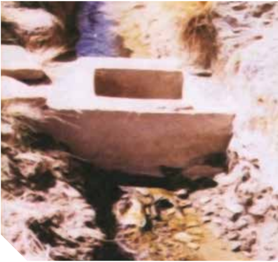
▲ Galería Realenga; cámara de inspección
