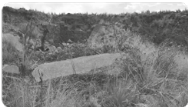
Fig. 36. Loza de Hormigón colapsada en el Baluarte 2.
