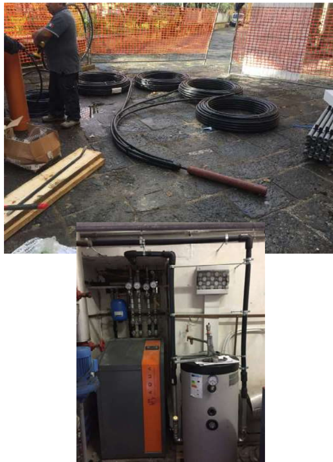
Figura 33 Pompa di calore geotermica con sonde verticali installate presso il sito dimostratore di Largo San Marcellino- Napoli (fonte:Craveb)
