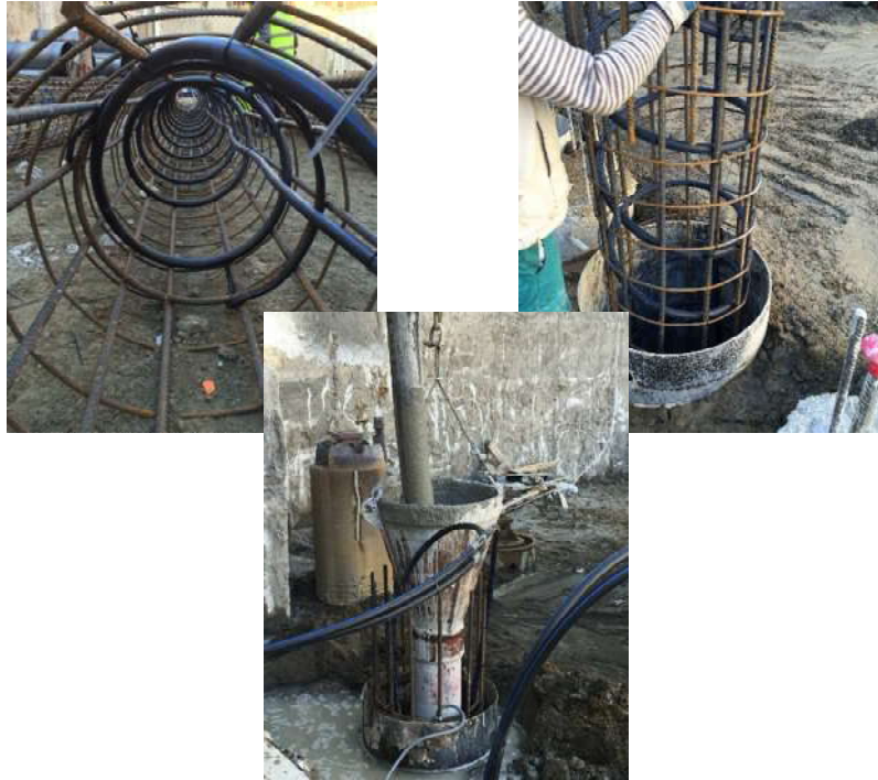
Figura 32 Installazione dei pali energetici presso la metropolitana di Napoli-stazione Municipio (fonte: Consorzio CRAVEB)
