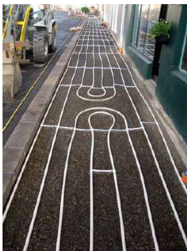
Figura 36 Riscaldamento geotermico dei marciapiedi per eliminare il ghiaccio (fonte: https://wowair.us/magazine/energy-in-iceland/ )
