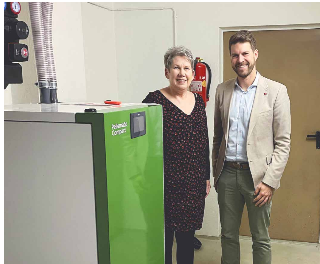
Bürgermeister Christoph Wolf und Gabriele Jäger-Jurasovitch bei der neuen Pelletsheizung. Die gesamten Arbeiten wurden von Hornsteiner Firmen durchgeführt.
