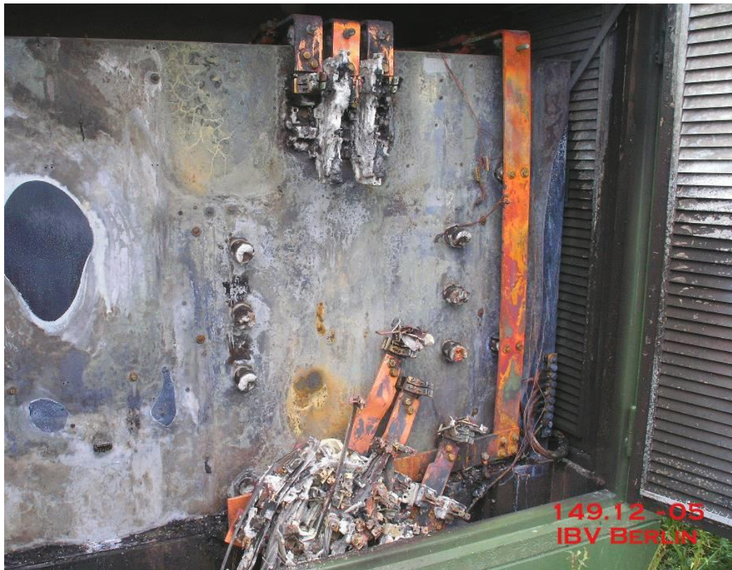
Bild 23, 24 und 25 : typische Störungsbilder bei Schutz durch HH-Sicherungen und Einwirkzeiten \gt 10 s
