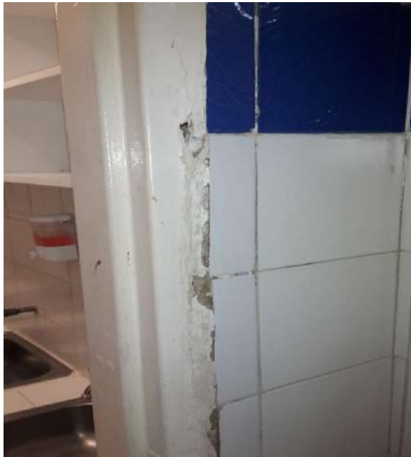
Baldosas rotas en la zona de cocina
