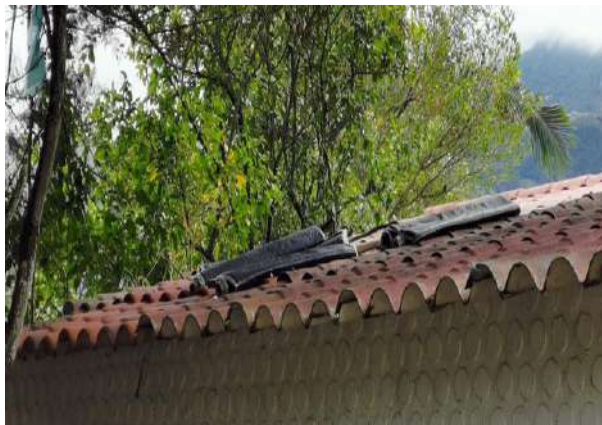
Tela asfáltica en desuso en techos de la cocina
