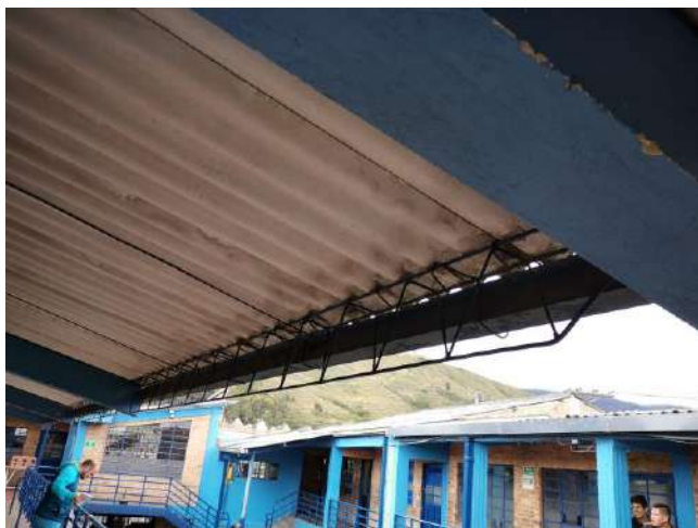
Techos del segundo piso sin mantenimiento
