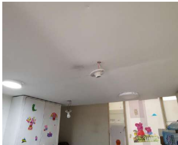
Techo de la Enfermería con deficiencias en su cableado
