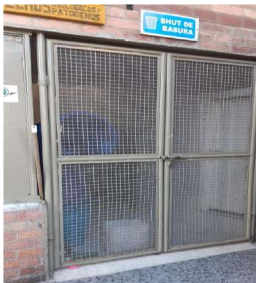
Puerta inadecuada y espacios sin angeo
