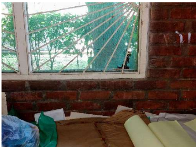
UPI El Edén: Papelería expuesta a deterioro por angeo roto
