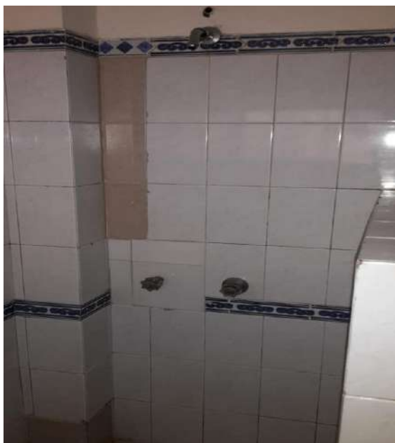
Llaves de la ducha dañadas, baño segundo piso
