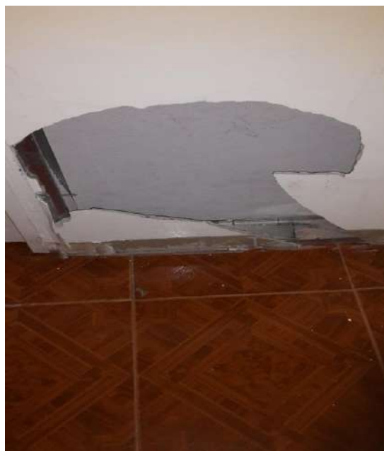
Paredes rotas en la zona de enfermería
