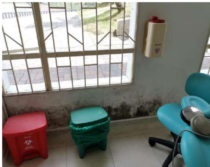
Humedad en las paredes de la Odontología
