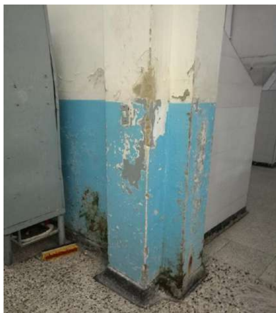
Muros de los dormitorios en mal estado y con presencia de humedad.
