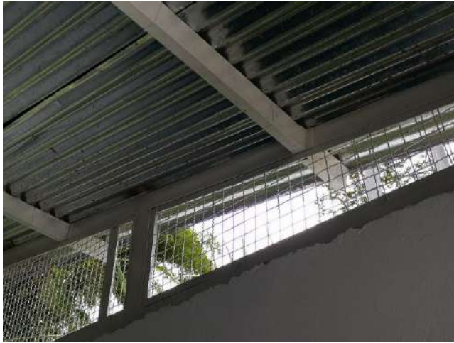
Techos sin materiales de fácil limpieza y sin angeo
