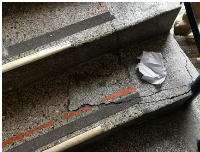
Escalones con grietas y con riesgo de accidentalidad
