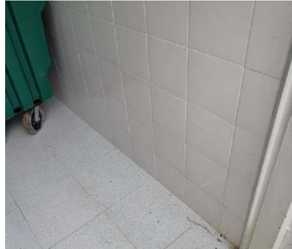
Los Shut de basuras no cuentan con uniones o mediacañas que faciliten su limpieza
