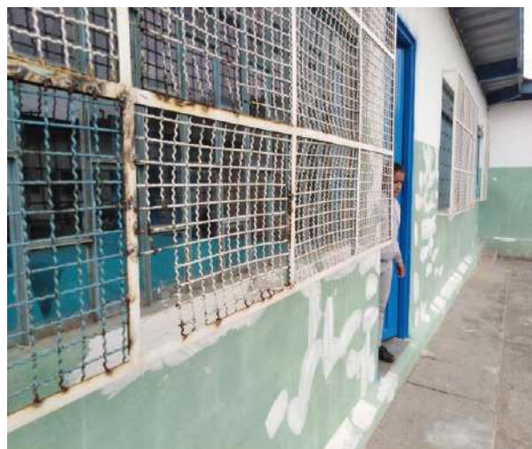
Mallas desoldadas y oxidadas, riesgo de accidentalidad para los NNAJ
