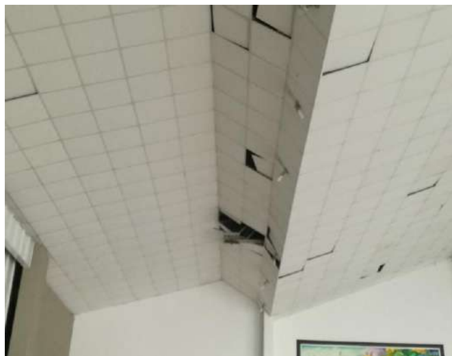
Techo del auditorio de la Upi sin mantenimiento hace más de 3 años. Existe riesgo de accidentalidad para los NNAJ.
