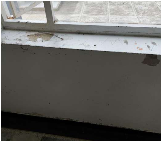
Pared del segundo piso, zona comedor en mal estado
