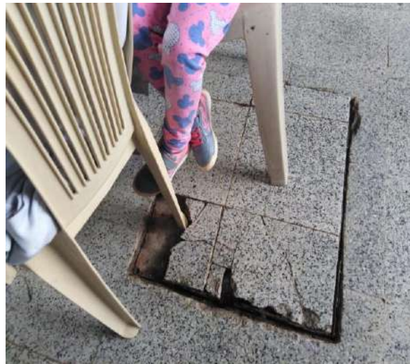
Baldosas rotas y con presencia de óxido, adicionalmente riesgo de accidentalidad
