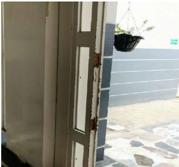
La unidad no cuenta con puerta en su entrada principal
