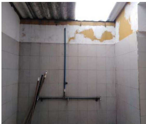
Presencia de goteras en la zona de baños, falta de pintura y mantenimiento a paredes
