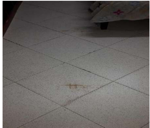
Pisos con presencia de oxido
