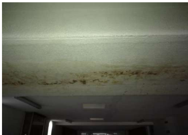
Techos de los dormitorios con presencia de humedad lo que aumenta el riesgo de contraer enfermedades respiratorias a los NNAJ del Instituto.
