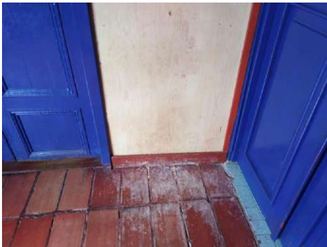
Presencia de humedad al ingreso de la casa
