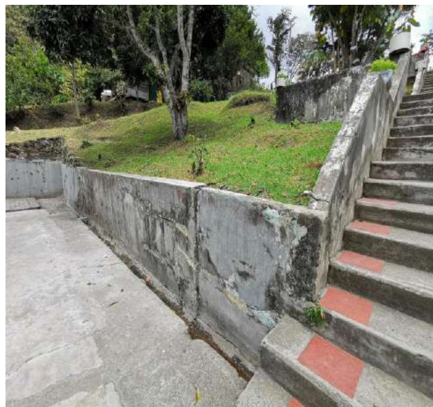
Zona de ingreso a la casa, con debilidades en su fachada
