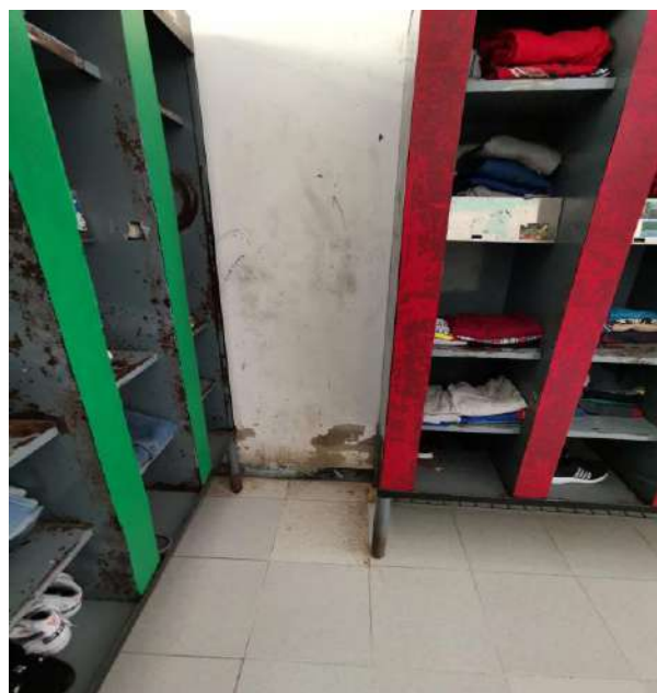
Zona de dormitorios con presencia de humedad en paredes
