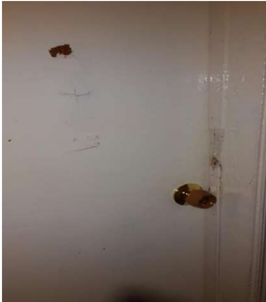
Puertas de la Unidad en mal estado
