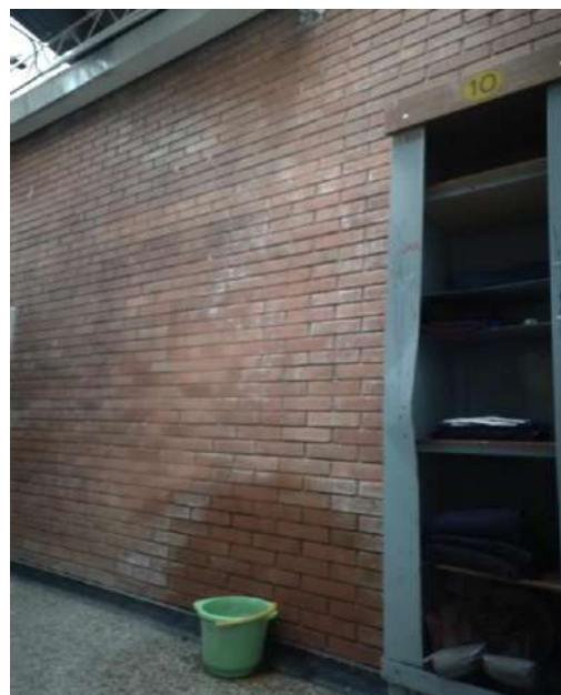
Inundaciones en dormitorios debido a canaletas para aguas lluvias dañadas, existe riesgo de accidentalidad
