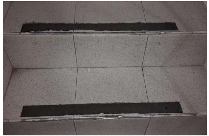
Cinta antideslizante en mal estado, instaladas en marzo de 2019
