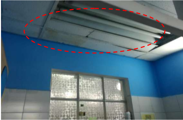
Techos en mal estado y con humedad
