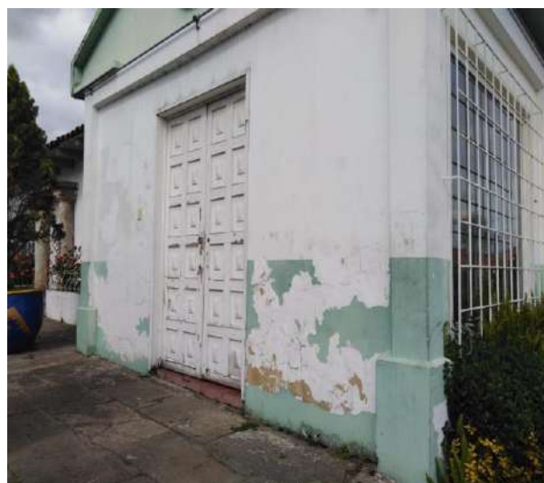
Falta de mantenimiento a la fachada de la unidad
