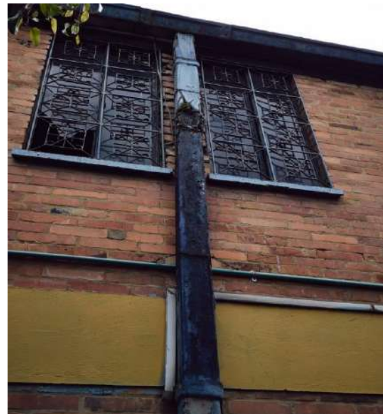
Canal y bajante de agua lluvia rota
