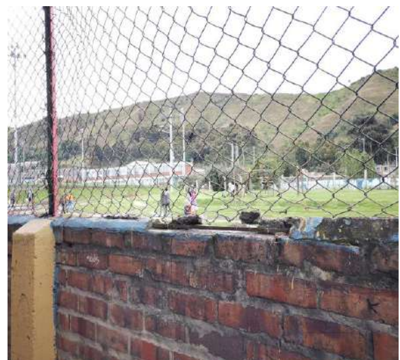
Mallas desoldadas y muros en mal estado
