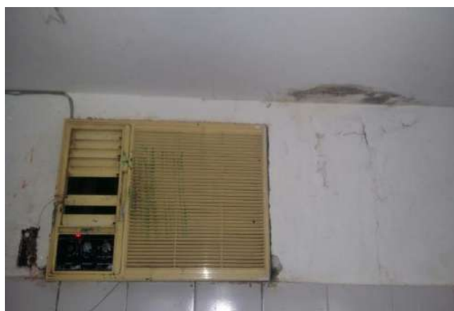
Aires acondicionados dañados, sin programación de mantenimiento
