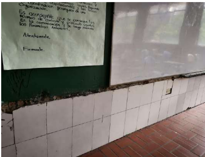
Baldosas rotas en aulas del segundo piso
