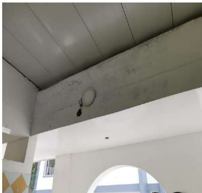
Zona de duchas piscina, con goteras y humedad en techos
