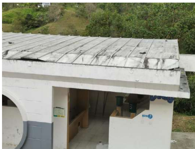
Techos de los baños de la piscina en mal estado
