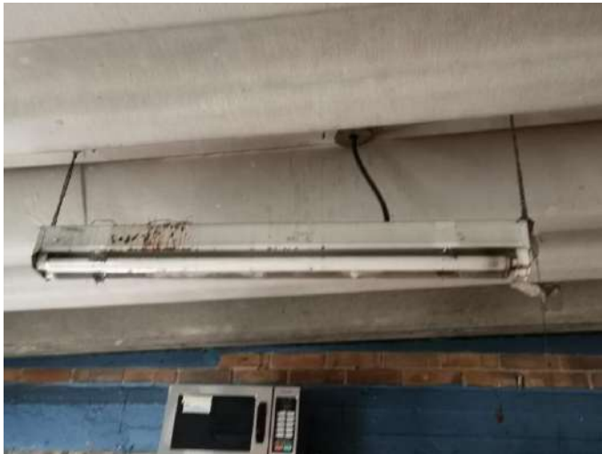
Salones de clase con falencias en su iluminación
