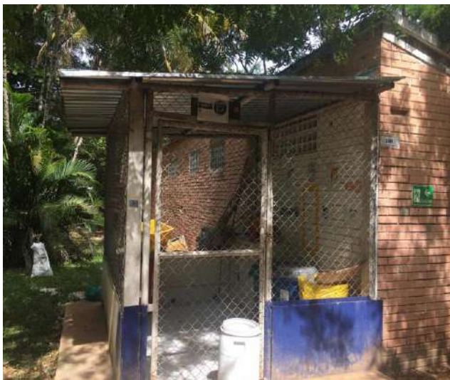
Shut de basuras sin el cumplimiento de las Especificaciones establecidas en la norma
