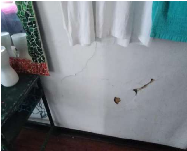
Paredes en mal estado en los dormitorios de las señoras de cocina.
