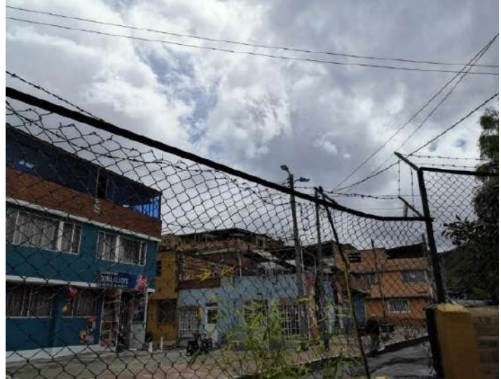
Mallas de la Unidad caídas y desoldadas, lo que afecta su seguridad
