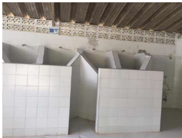
Baños con necesidad de pintura y mantenimiento a pisos y techo
