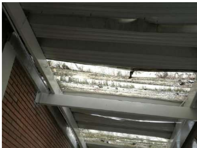
Tejas en mal estado, presencia de goteras en los dormitorios.
