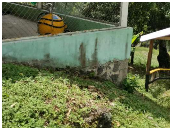
Humedad en la zona exterior de la lavandería
