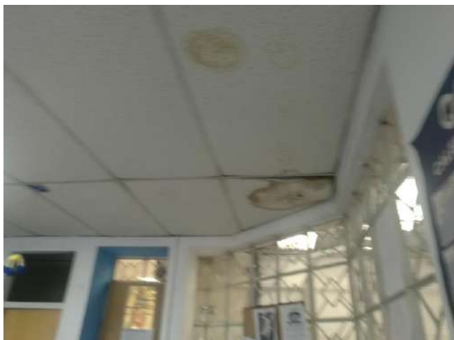
Techos en mal estado y con humedad en oficinas y salones dañado
