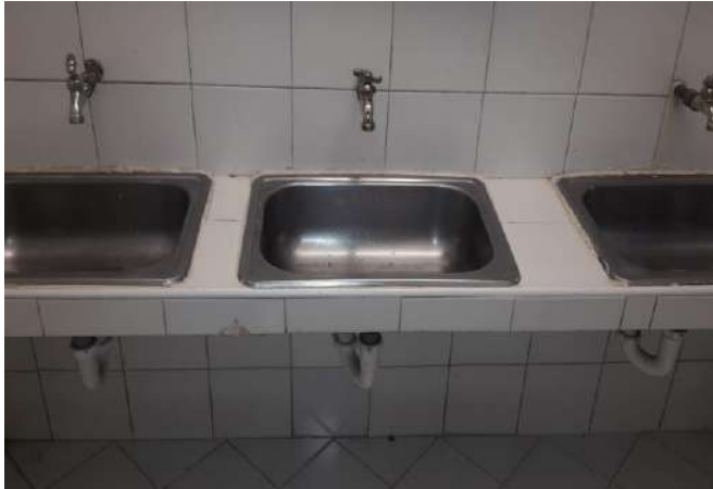
Presencia de goteras en la zona de cocina
