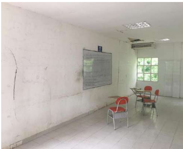
Paredes y pisos en mal estado para el desarrollo de clases
