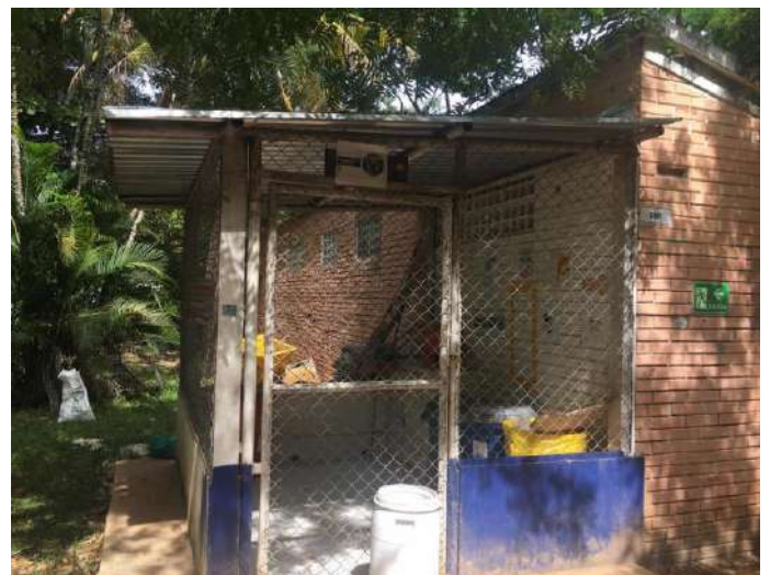
Shut de Basuras sin los requisitos de norma, presencia de insectos y plagas
