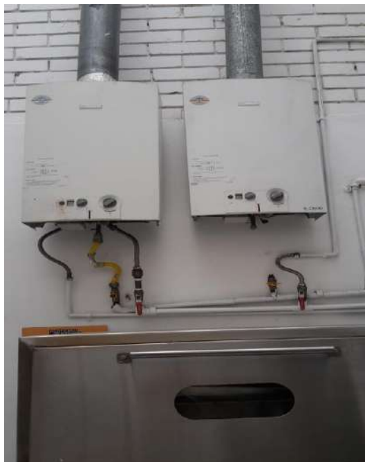
Calentadores de agua dañados
