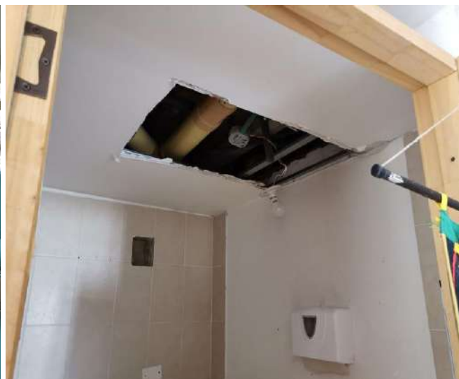
Techos sin mantenimiento en la misma zona
