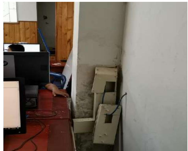
Canaletas dañadas y pared con humedad en aula de sistemas
