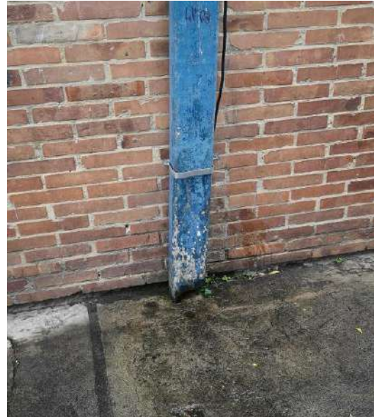
Canal oxidada y en mal estado
