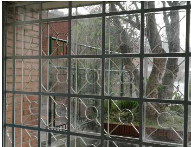
Vidrios rotos en los dormitorios, lo que causa Presencia de insectos en esta zona.
