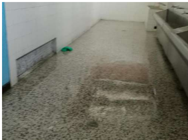
Inundaciones en la zona de los baños de dormitorios debido a canaletas dañadas, riesgo de accidentalidad
