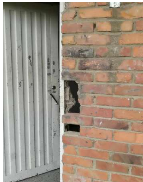
Aulas de clase con deterioro en su Infraestructura
