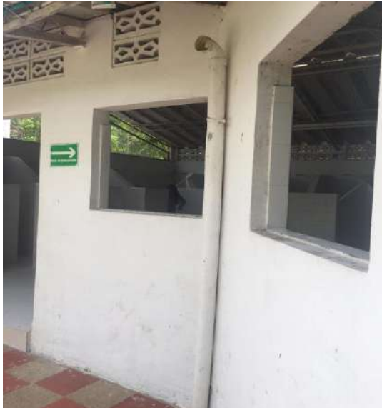
Canal y paredes del baño en mal estado
