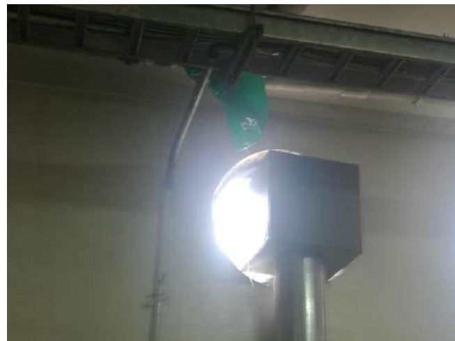
Presencia de goteras en la zona de lavandería debido a tubo dañado
