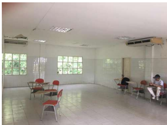
Salón para clases con techo y aire dañado
