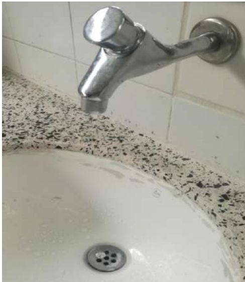
Llave de lavamanos dañada
