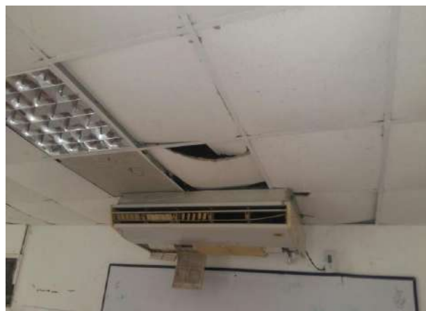
Techos en mal estado y con riesgo de accidentalidad
