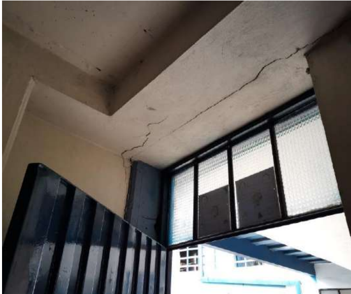
Presencia de grietas en los techos de la zona de baños
