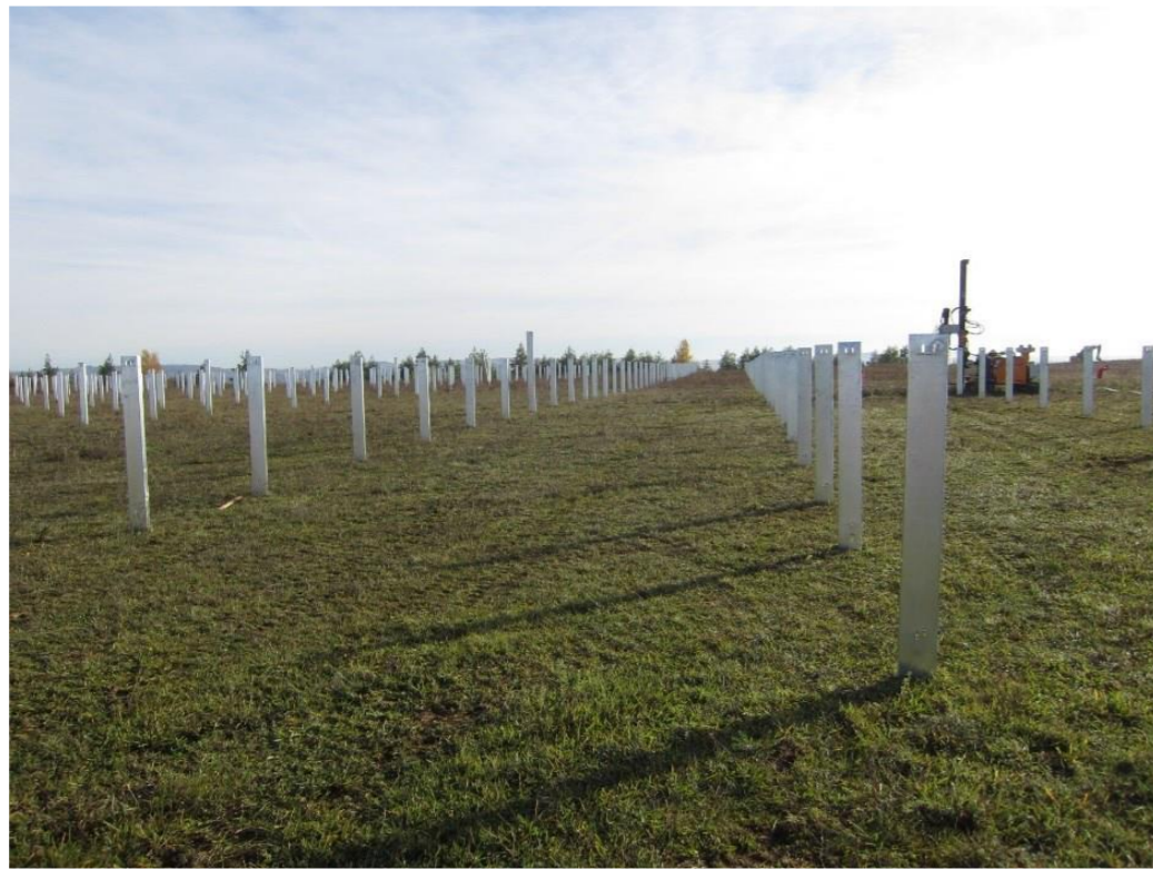
Figure 78 : Exemple de pieux battus dans le sol avec une batteuse visible en arrière-plan
