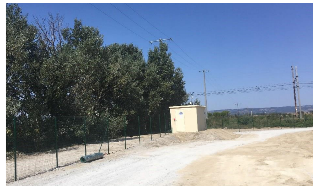
Figure 72 : Exemple d'un poste de livraison
