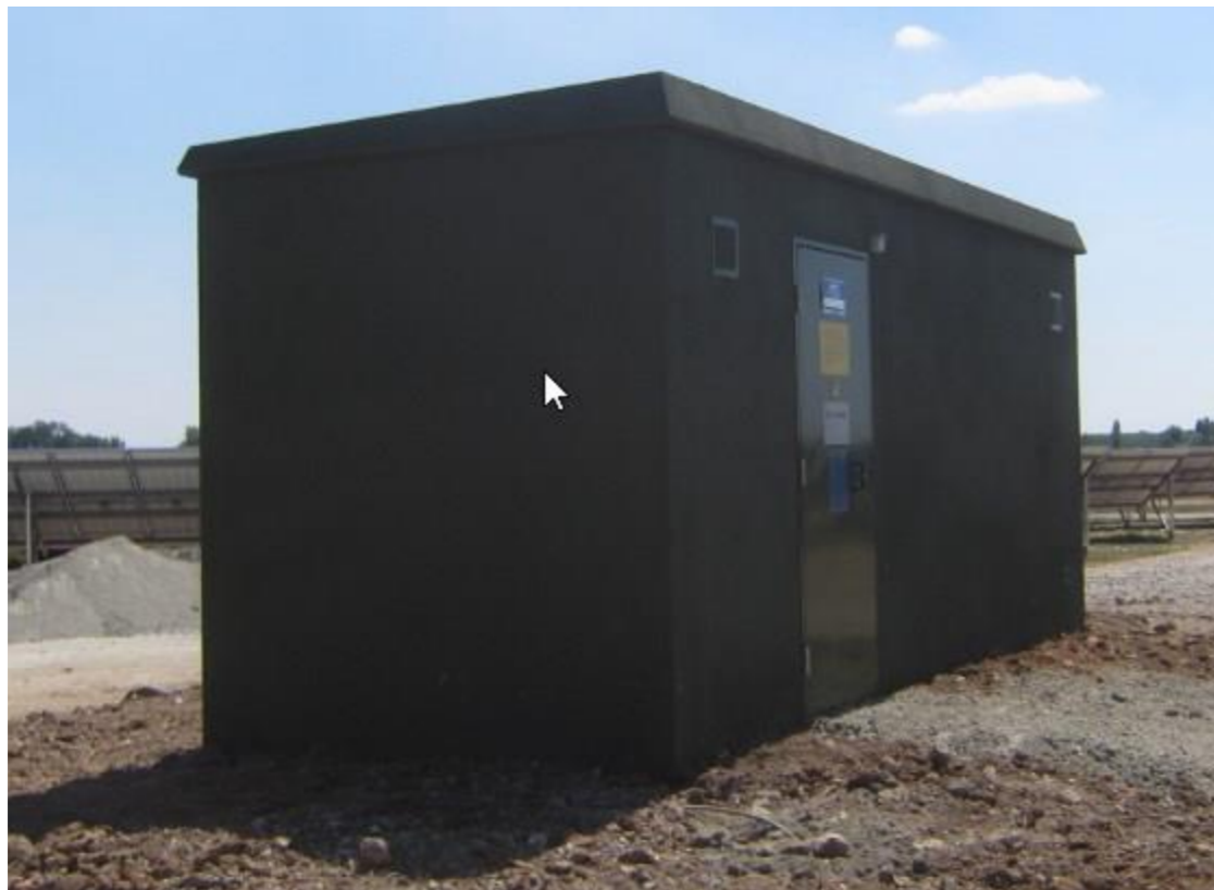
Figure 70 : Exemple de poste de conversion « indoor »
