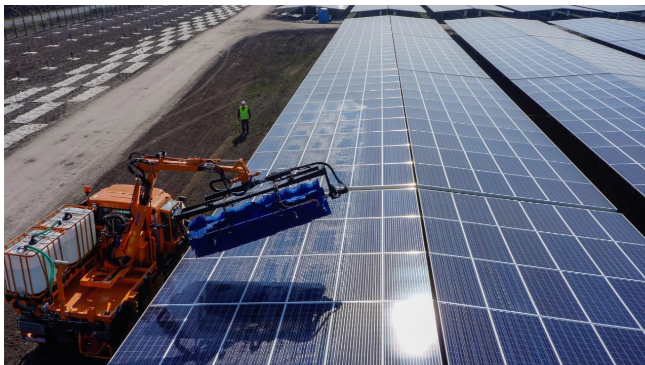
Figure 82 : Exemple de procédé de nettoyage des modules
