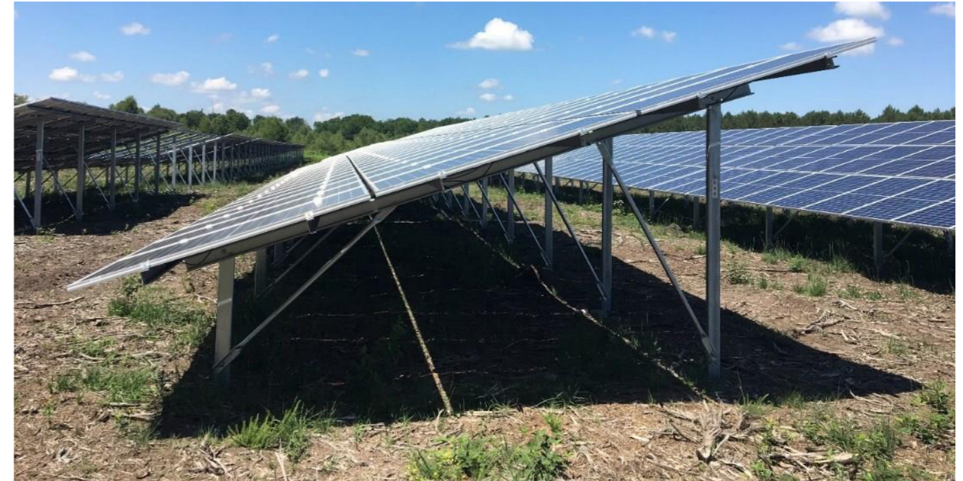
Figure 79 : Exemple de structure de tables fixes
