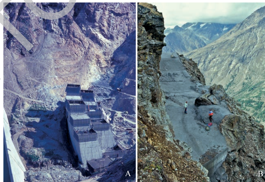
Fig. 123 - Diga di Place Moulin. (A) Il cantiere e l'avandiga dalla spalla destra. (B) Consolidamento ed impermeabilizzazione dell'ammasso kinzigitico fratturato alcune centinaia di m sopra la spalla sinistra della diga di Place Moulin.
