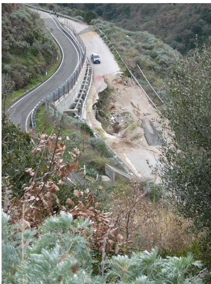
Figura 25.11 Strada provinciale n°41 bis Ittiri-Banari; frana di Scivolamento rotazionale unita a crollo su ignimbriti lapidee, a carico di un substrato alterato di piroclastiti, Comune di Ittiri (SS).
