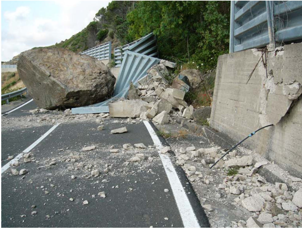
Figura 25.8 Punta Spinosa Strada Statale n°134 (tratto Castelsardo-Sedini). I blocchi di Ignimbrite (fino a 50 m 3 ) hanno invaso la sede stradale dopo aver rotolato sul versante per circa 100 m, aver travolto il muro di cemento armato e la barriera paramassi.
