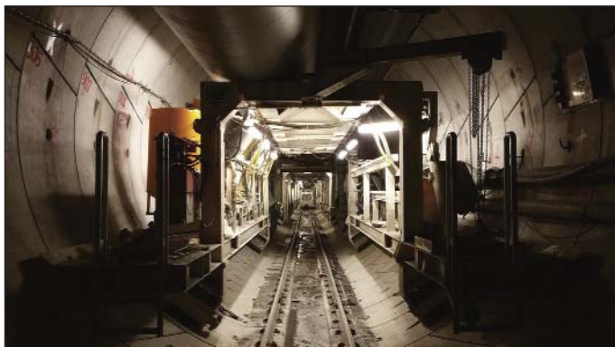
Obr. 9 Pohled na návěs TBM Fig. 9 A view of the TBM trailing gear
