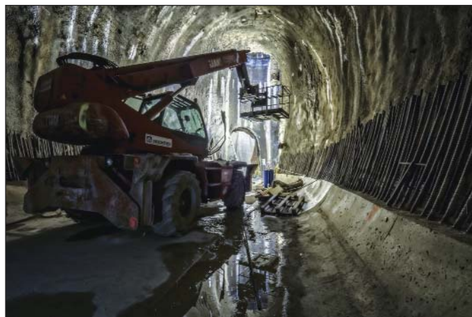
Obr. 2 Technická komora TK 101 – provádění definitivního ostění a injektáže primárního ostění Fig. 2 Technical chamber TK 101 – installation of final lining and back grouting behind primary lining
