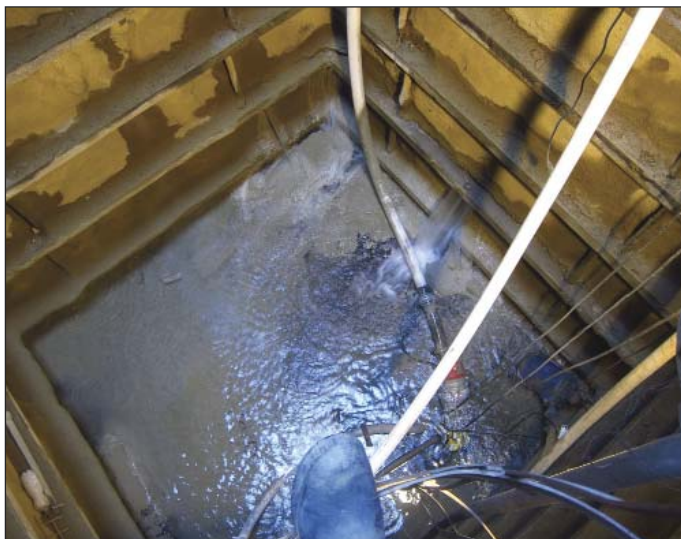
Obr. 6 Silné přítoky do šachty Š2 Fig. 6 Strong inflows into shaft Š2
