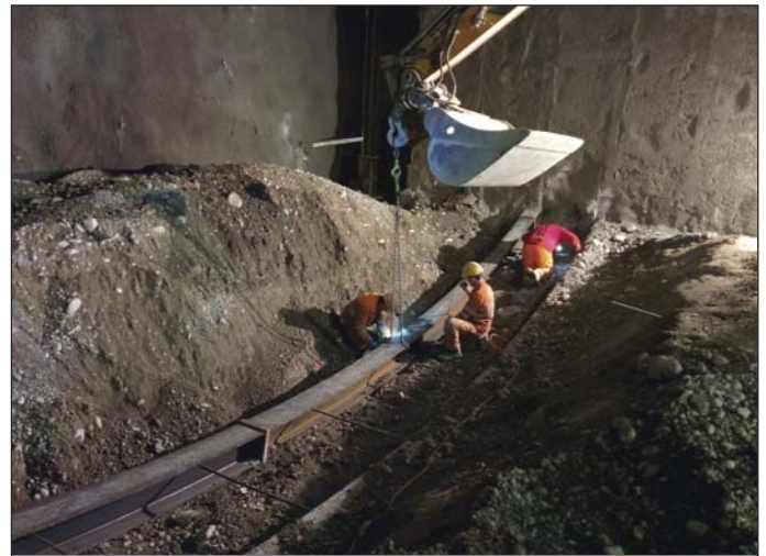
Obr. 7 Inštalácia válcovaných profilov v spodnej klenbe Fig. 7 Installation of a rolled-steel section in the invert
