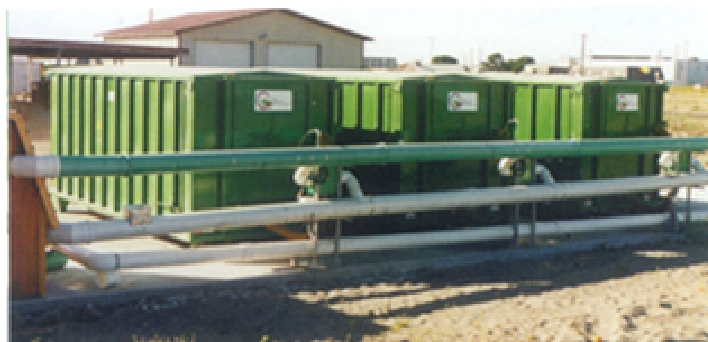
Σχήμα 3-6 Σύστημα κομποστοποίησης σε κιβώτια
