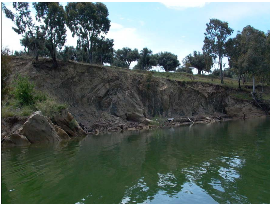
Figura 2.4 : Serbatoio Pozzillo - Il materiale localmente franato viene gradualmente trasportato nel serbatoio dall'azione del moto ondoso.
