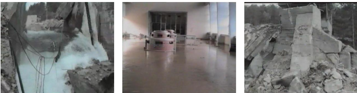
Figura 5 - Gli effetti del bombardamento della diga di Peruca: rilascio d'acqua incontrollato in sponda sinistra; allagamento della centrale di produzione elettrica; danni alla spalla in sponda sinistra della diga.
