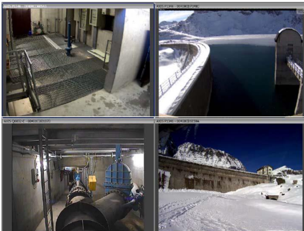
Visualizzazione telecamere presso la casa di guardia nei locali dedicati della centrale di Dietro la Torre
