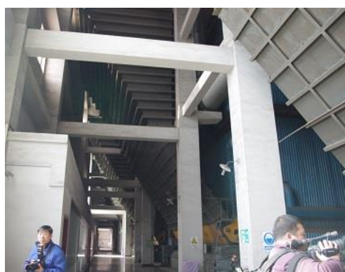
图 1 太原街集中供热 锅炉
