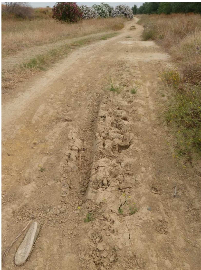
Firme en mal estado en un tramo del cordel
