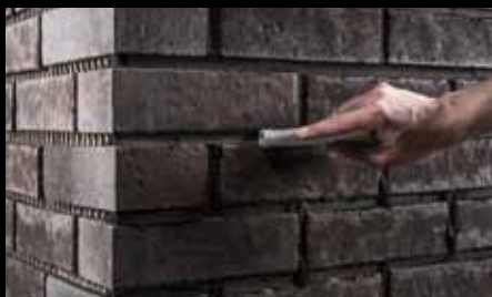
Dle typu náradí pro zhuštění a vyhlazení spáry vznikne konečný tvar spáry, rovná, zapuštěná, půlkruhová, apod.
