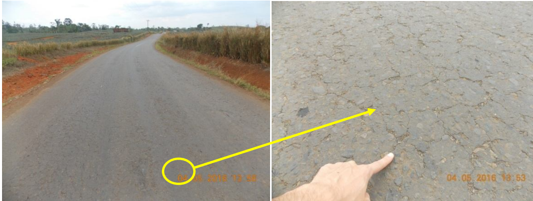
Figura 19. Agrietamiento de riego final de impermeabilización en huella del tránsito. (Condición superficial 2 años después de construcción)
