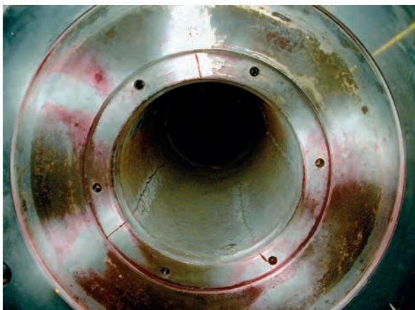
Abb. 10.1: Spannungsrisse in wassergekühlter Rollenpresswelle durch Umlauf- und Druckbeanspruchung
