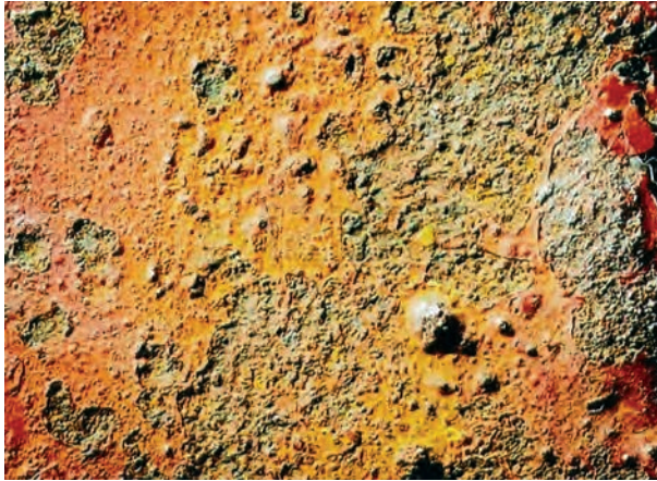
Abb. 10.2: Wasserbeaufschlagte Innenwand der Presswelle mit Rostpusteln unter denen Muldenfraß entstanden
