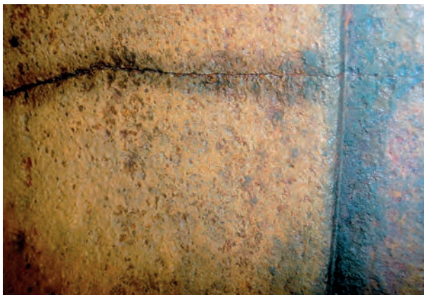
Abb. 10.3: Spannungskorrosion mit wasserstoffinduzierter Rissbildung
