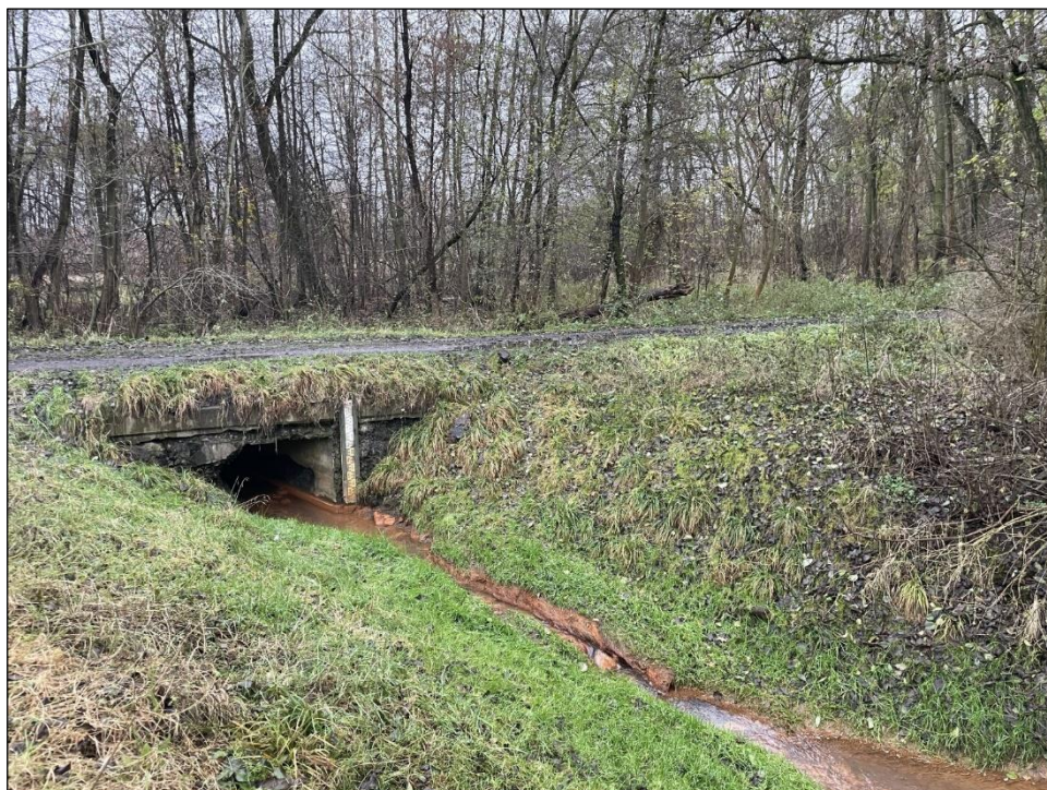
Obrázek 1: Výtok vody ze zatrubnění do Libišské svodnice
