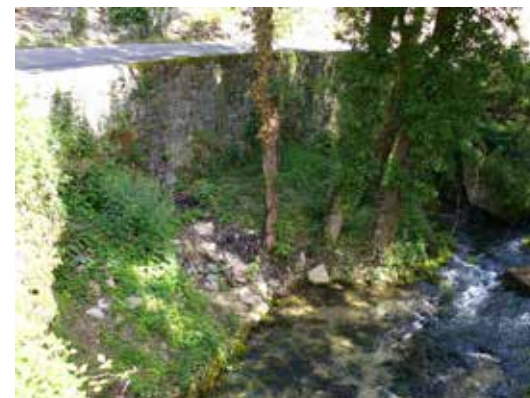
Résurgence des Pareyres aux Vignes avant travaux © Conseil Départemental de la Lozère
