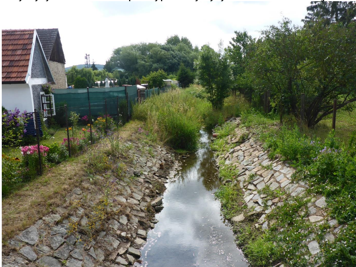
Obrázek 10.81: ř. km 9,410 - pohled po proudu Suchomastského potoka s korytem tvaru lichoběžníku s břehy opevněnými dlažbou do betonu (v místě silničního mostu), jež se místy, převážně v patě rozpadá, v korytě výskyt hlinitého sedimentu a průtočný profil místy s výskytem mokřadní vlhkomilné vegetace
