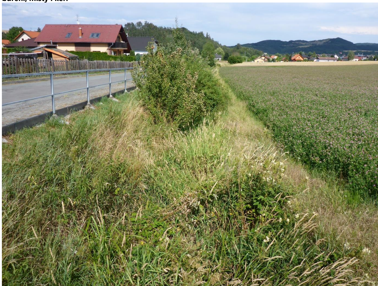
Obrázek 10.74: ř. km 2,290 - pohled po proudu Počápského potoka úzkým korytem celém zarostlém buřní, místy i keři
