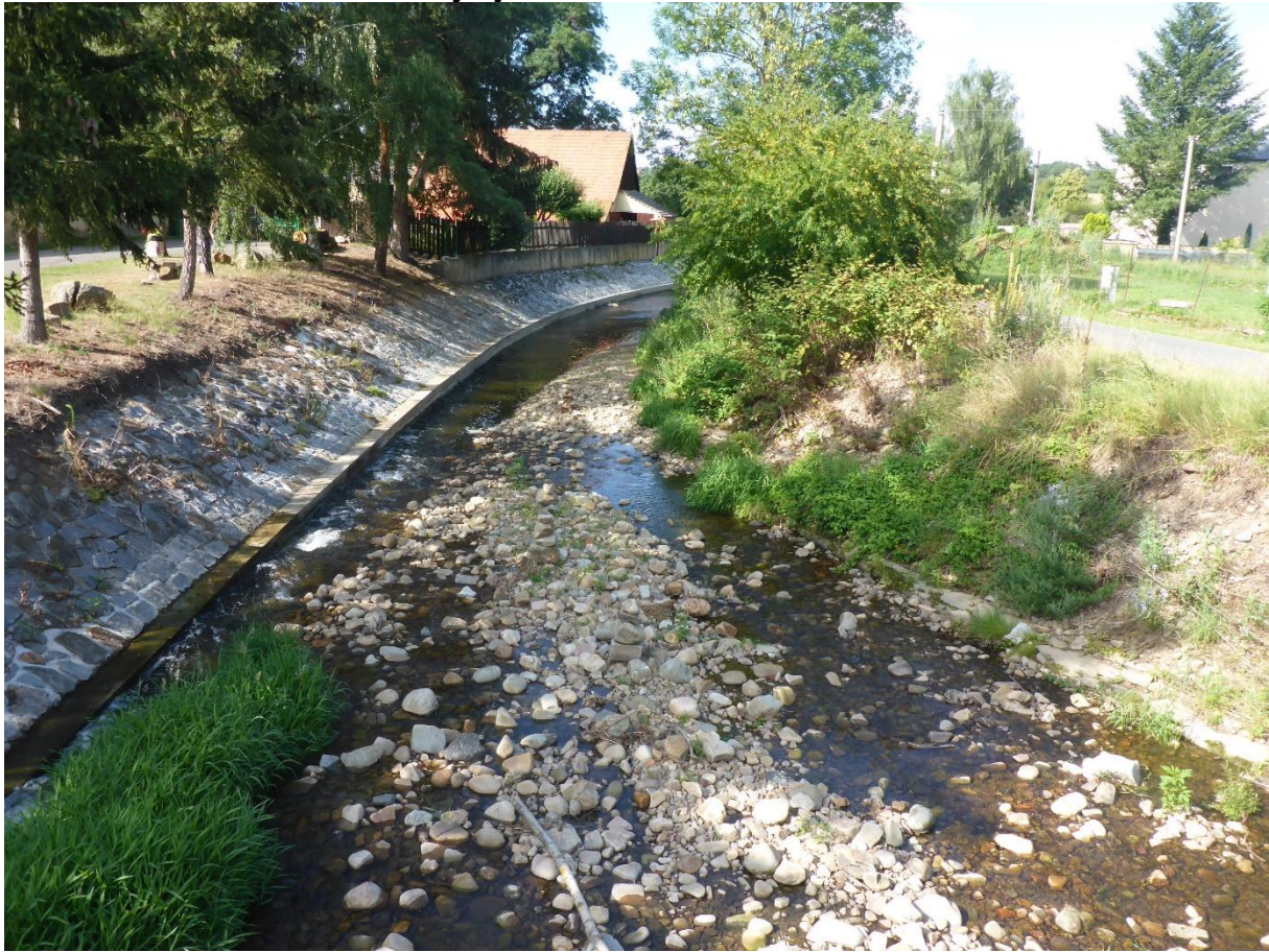
Obrázek 10.76: ř. km 3,660 - pohled po proudu Červeného potoka v intravilánu s levostraně opevněným břehem dlažbou do betonu, dno v korytě je kamenité
